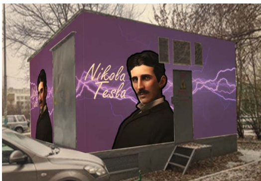
Рис. 2. Трансформаторная подстанция после экодизайна
