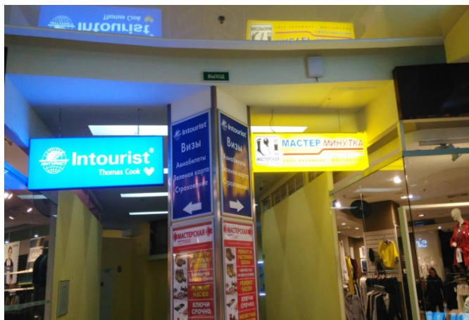
Рис. 1. Размещение светового пожарного оповещателя «Выход» в торговом центре «Атмосфера» г. Санкт-Петербург
