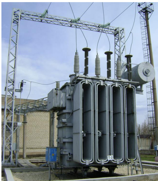
Рисунок 3 – Силовой трансформатор Т-2
