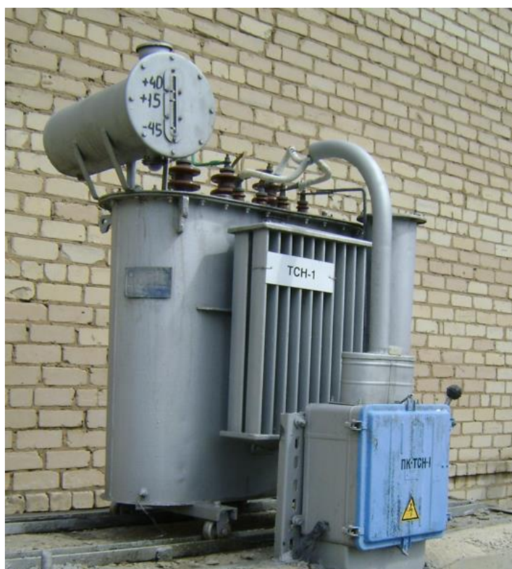
Рисунок 5 – Трансформатор собственных нужд ТСН-1
