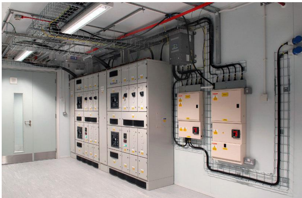
Рисунок 2 – Электрощитовая современного многоквартирного дома
