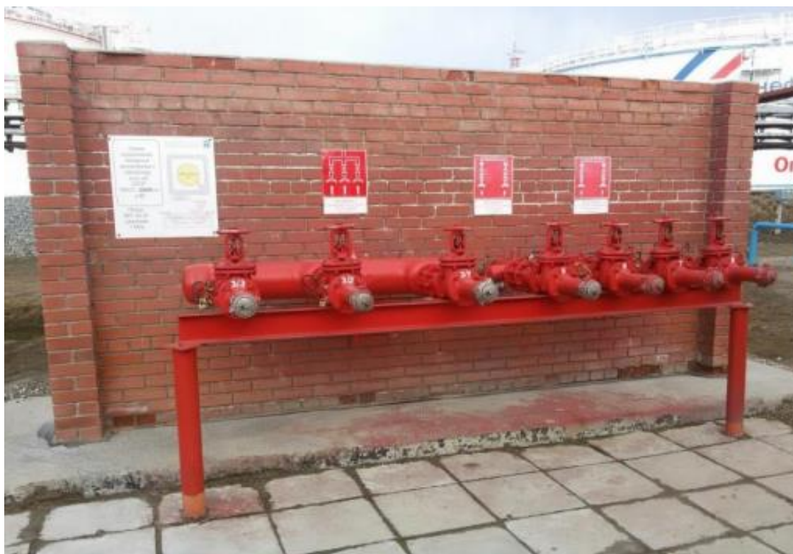
Рисунок 3 – Напорный узел СППТ ЛПДС «Сызрань-1» КРУ АО «Транснефть-Дружба»
