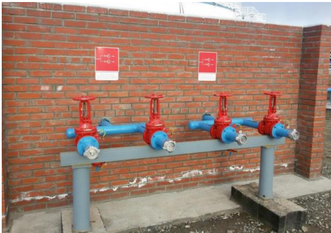
Рисунок 4 – Узел подключения водяного охлаждения ЛПДС «Сызрань-1» КРУ АО «Транснефть-Дружба»
