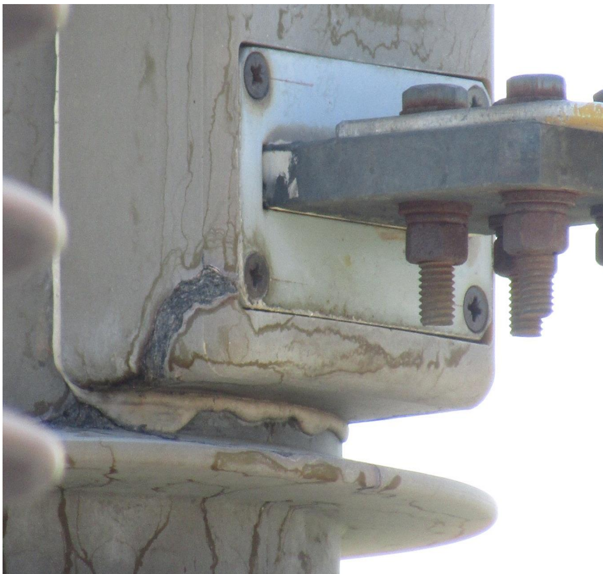
Рисунок 1 – Блок дугогасительный с КВД выключателя типа ВБПС-35Ш-25/630-1600 УХЛ1 НПП «Контакт» г. Саратов
