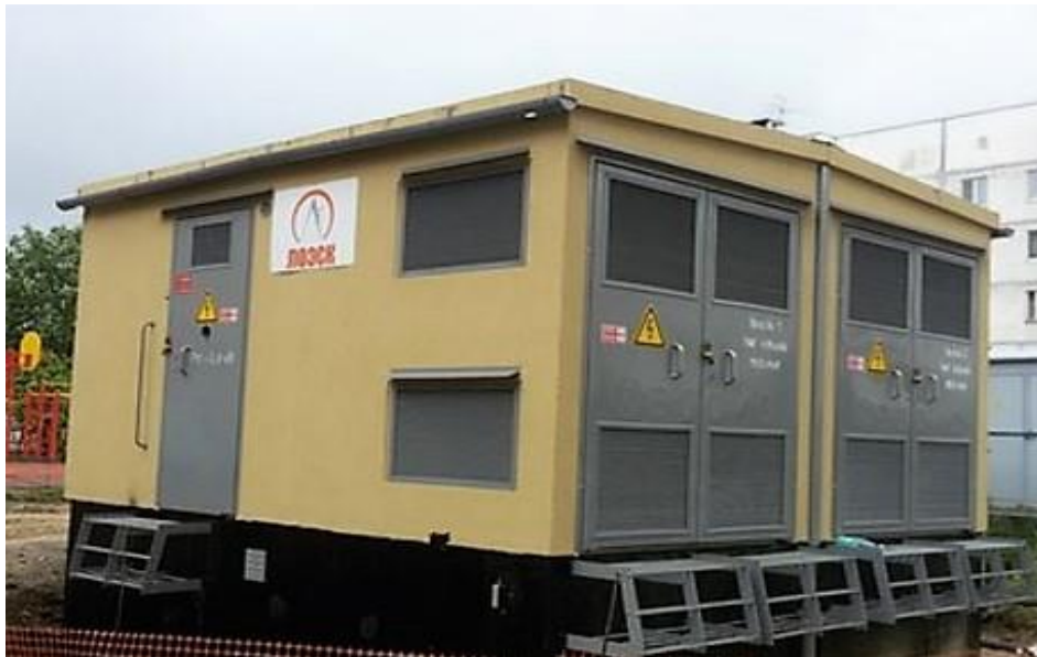
Рисунок 2 - Трансформаторная подстанция в железобетонном корпусе
