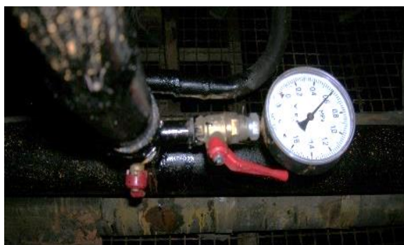
Рисунок 21 – Давление на вводе
