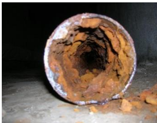
Рисунок 15 – Внутреннее состояние демонтированной магистрали
