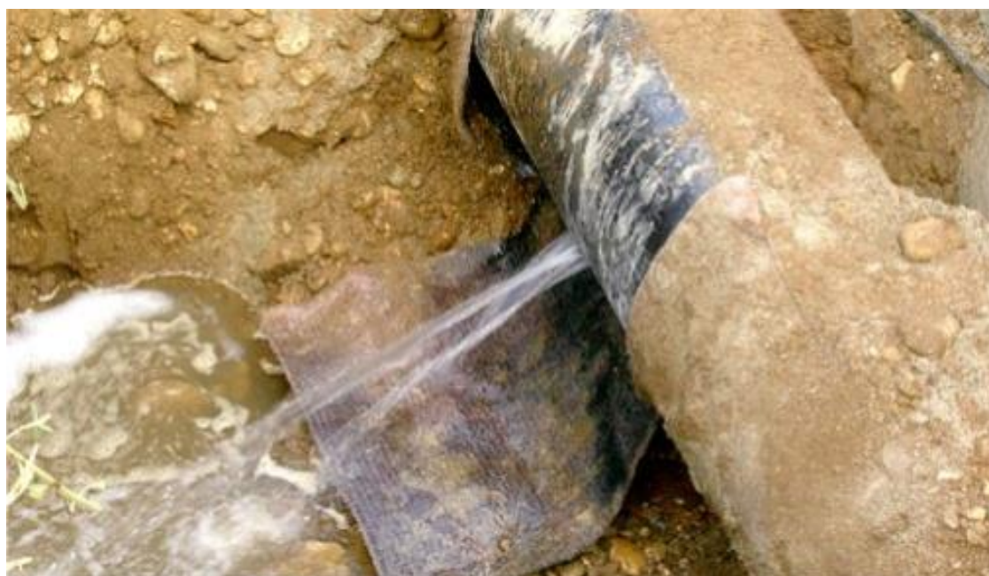
Рисунок 3 – Сквозная коррозия трубопровода
