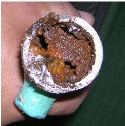
Рисунок 19 – Внутреннее состояние демонтированного стояка
