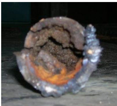
Рисунок 17 – Внутреннее состояние демонтированного стояка
