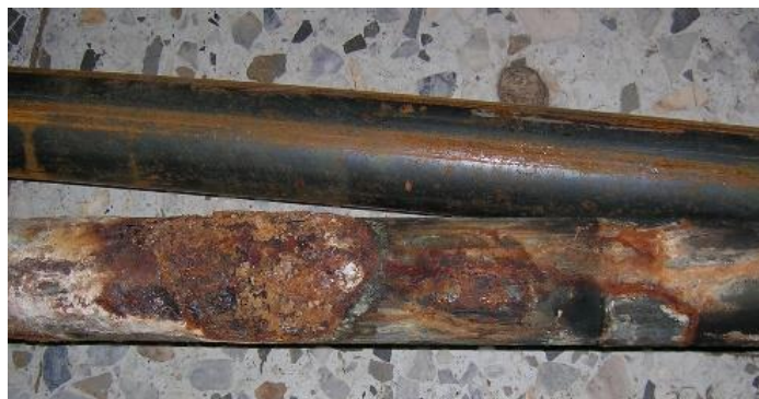
Рисунок 18 – Наружное состояние демонтированного стояка (сравнение с новой трубой)
