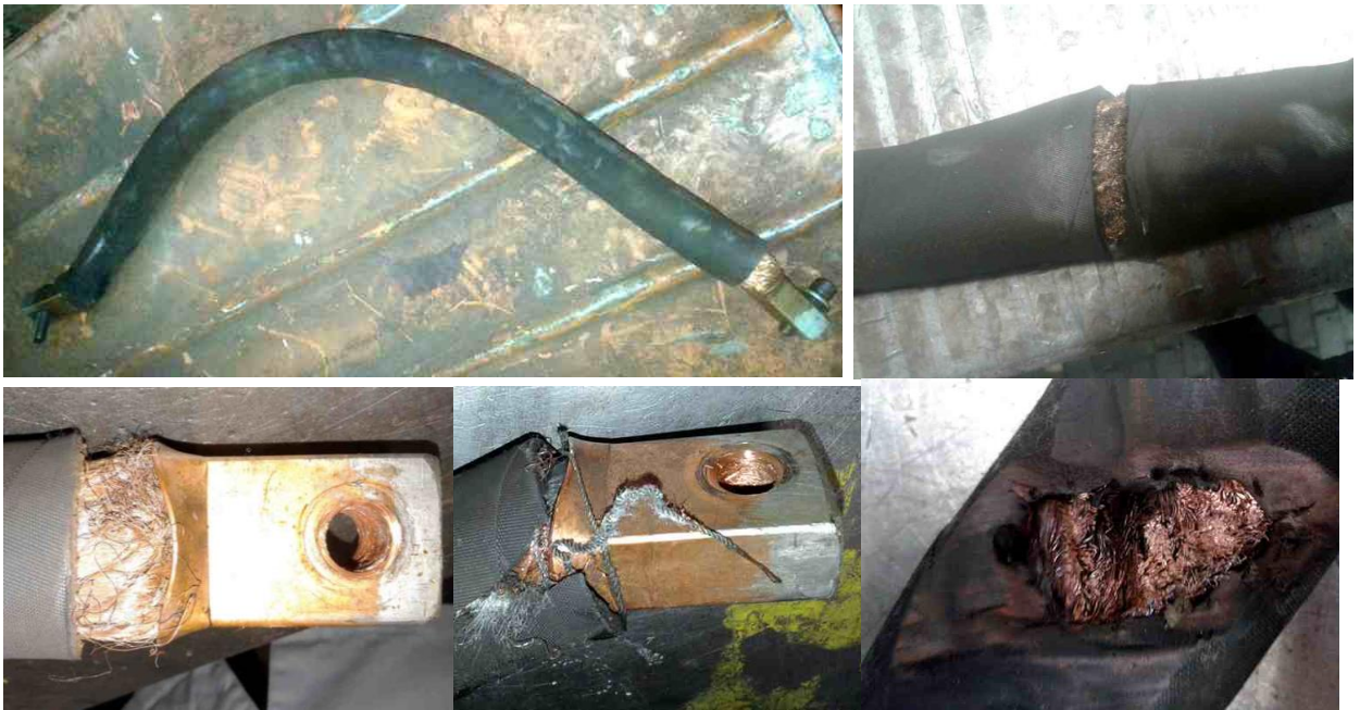
Рисунок 31 – Внешний вид и частичное разрушение токоведущей части гибких неохлаждаемых перемычек сечением 300 мм 2 после интенсивной сварки
