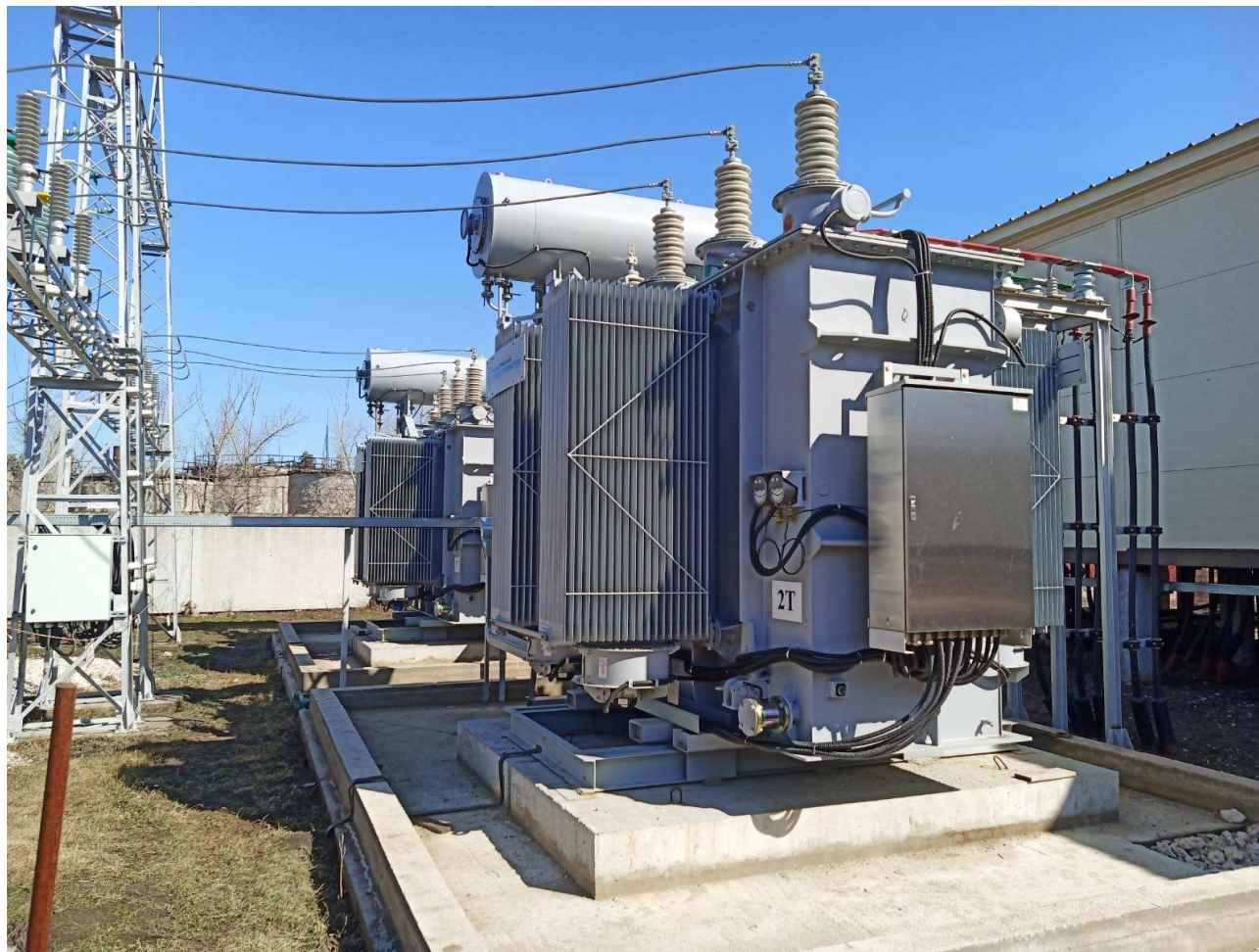
Рисунок В.3 – Фотография трансформатора 2Т
