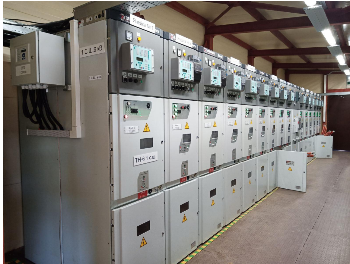
Рисунок В.1 – ЗРУ-6кВ. Фотография ячеек 1с.ш. с терминалами БЭ2502А
