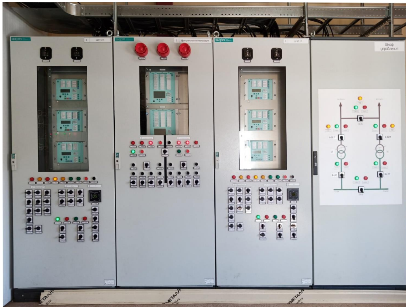
Рисунок В.2 – ОПУ. Фотография шкафов ШЭ2607 149
