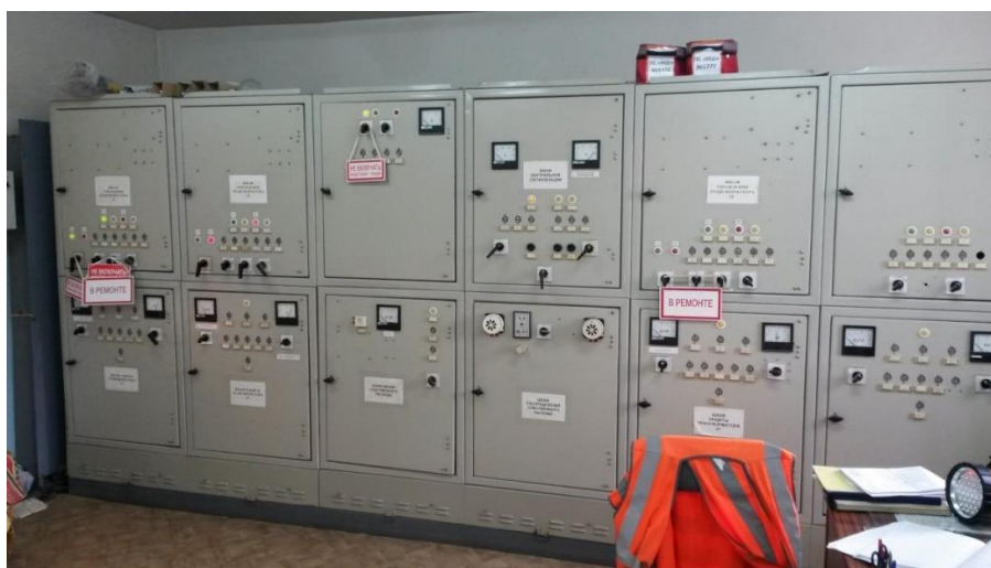
Рисунок 2 – Шкафы защит в ОПУ
