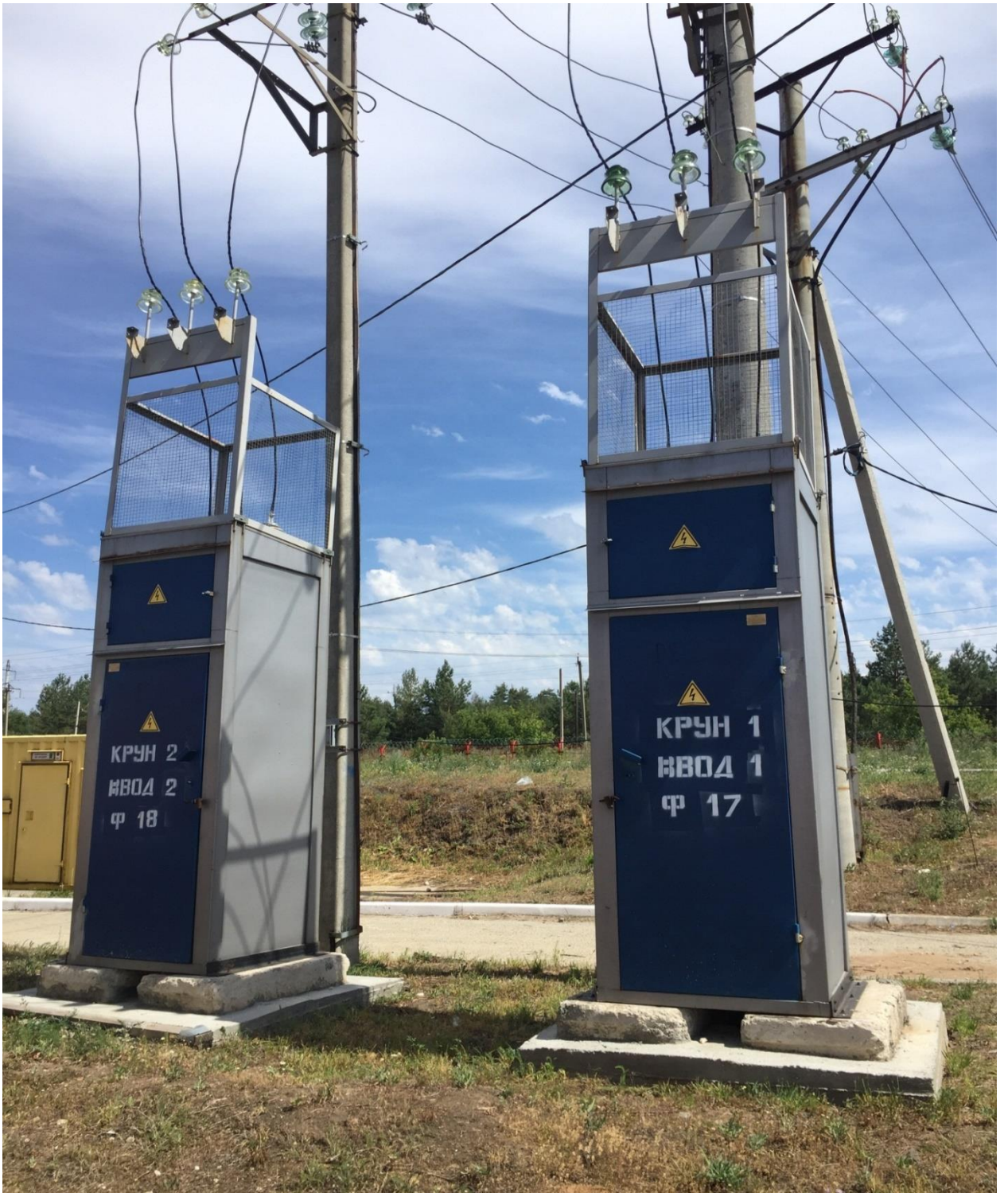
Рисунок 2- Комплектные распределительные устройства (наружные)
