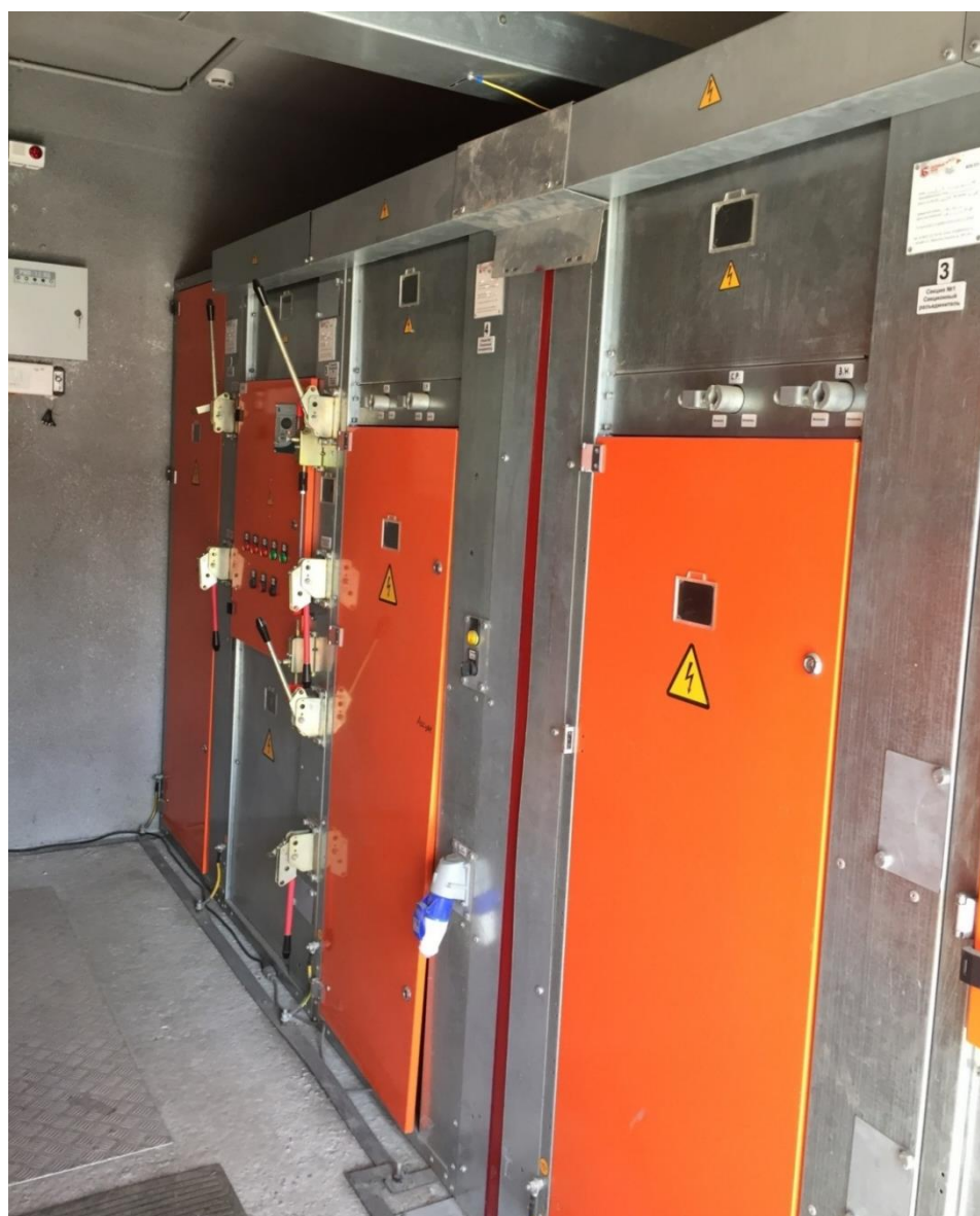
Рисунок 5 - Внутренний вид подстанции № 876
