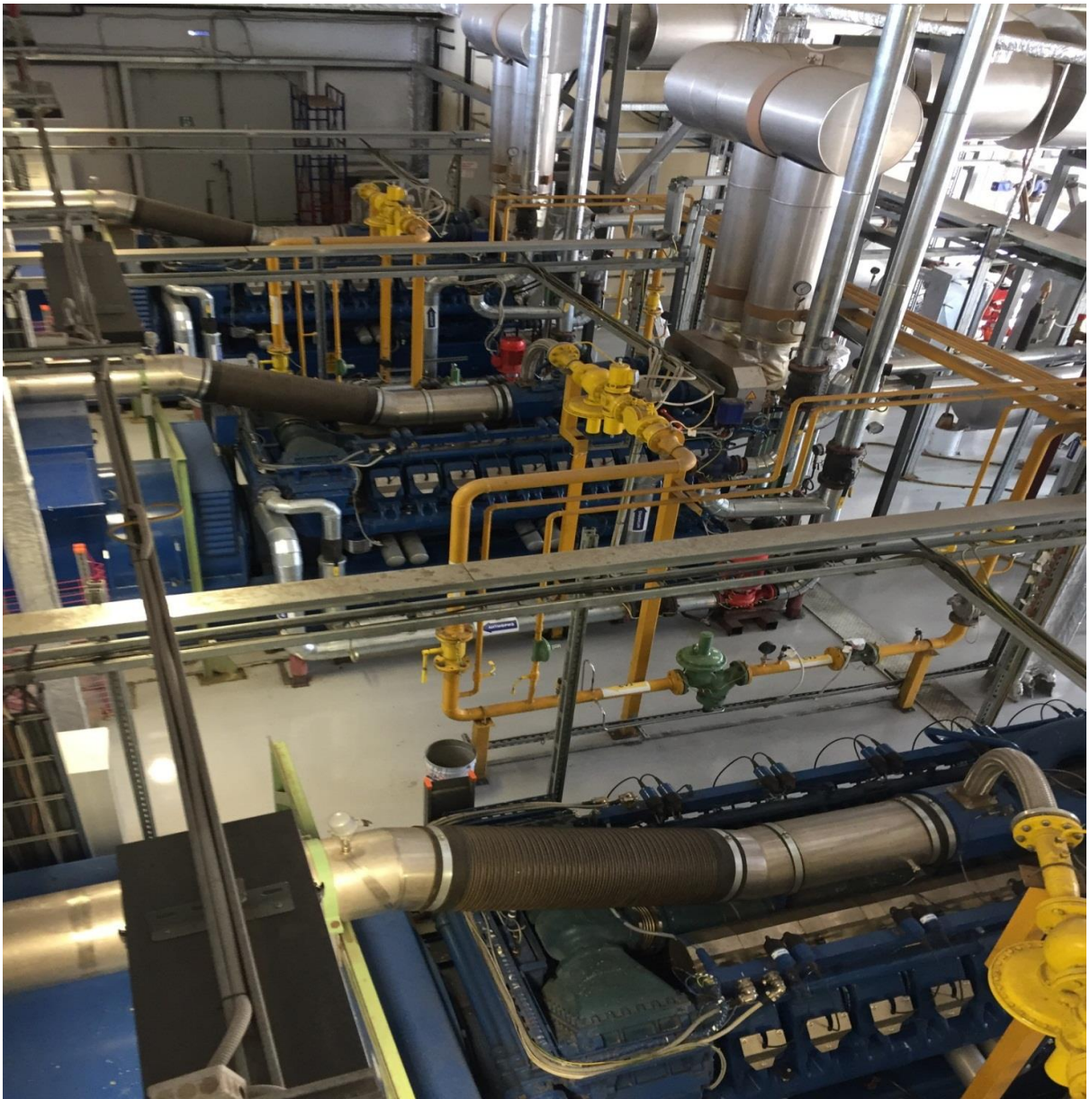
Рисунок 3 - Три газопоршневые установки мощностью 2 МВт
