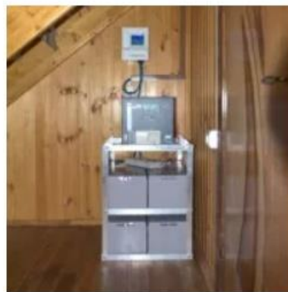
Четыре гелевых аккумулятора по 100АЧ и инвертор на 9КВт
