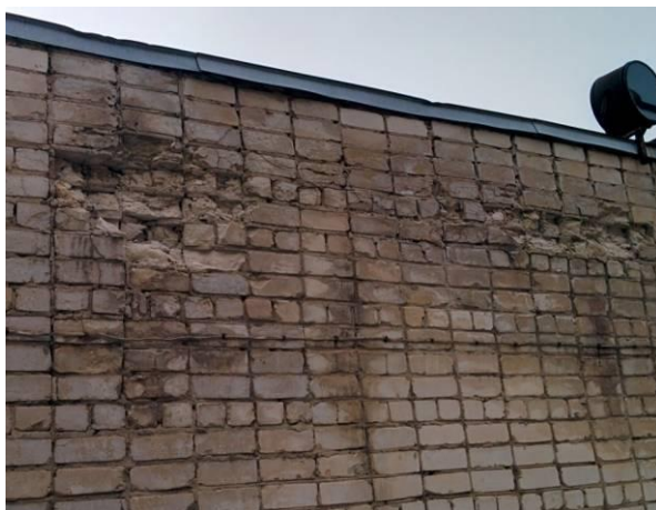
Рисунок 26 – Деструкция кирпичной кладки
