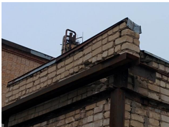
Рисунок 20 – Разрушение кирпичной кладки стены парапета
