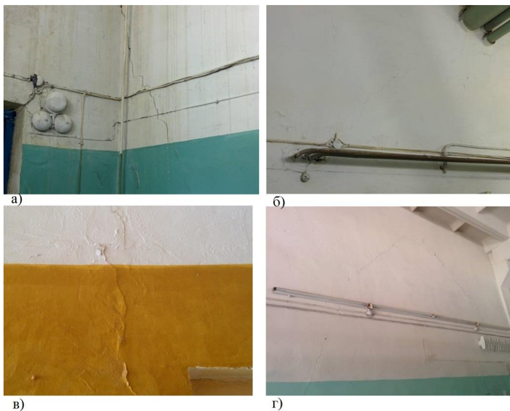
Рисунок 7 – Трещины в кирпичной кладке перегородок: а) наклонная трещина в перегородке на первом этаже в осях «Б–В/10–11»; б) наклонная трещина в перегородке на первом этаже в осях «А–Б/10–11»; в) вертикальная трещина в перегородке второго этажа в осях «А–Б/10–11»; г) наклонная трещина в перегородке второго этажа в осях «Б/10–11»
