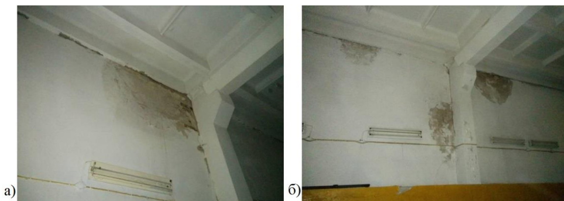
Рисунок 8 – Следы протечек стеновых конструкций: а) на отметке +11.300 м в осях «Г/8»; б) на отметке +11.300 м в осях «Г/1–3»
