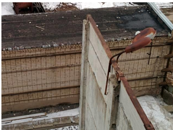
Рисунок 22 – Повреждения гидроизоляционного кровельного материала
