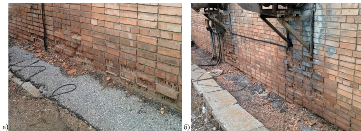
Рисунок 3 – Деструкция кирпичной кладки: а) цокольная часть кирпичной стены в осях «Г/1–2»; б) цокольная часть кирпичной стены в осях «Г/4–5»
