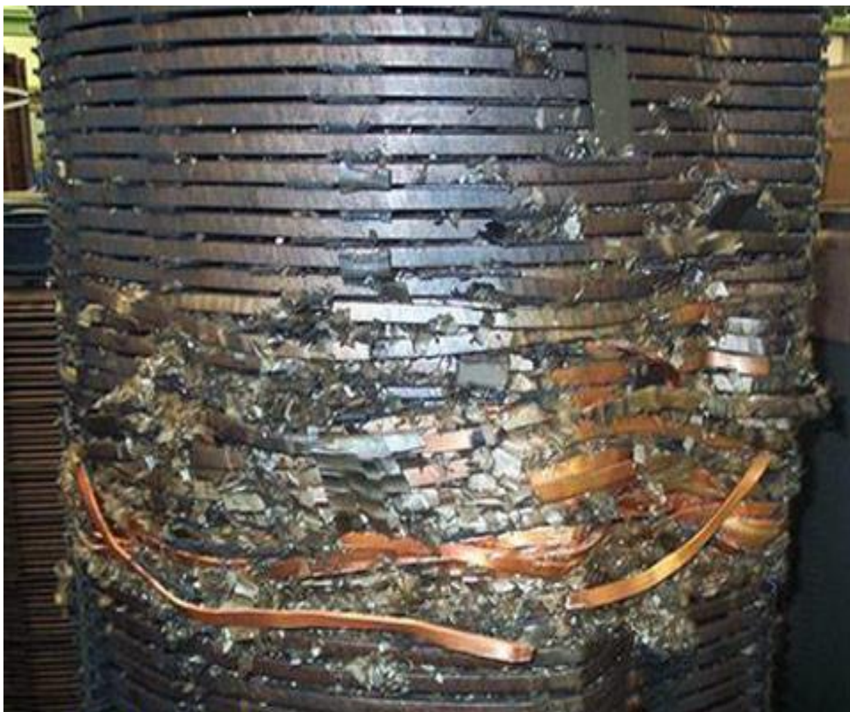
Рисунок 8 - Повреждение изоляции и обмотки трансформатора
