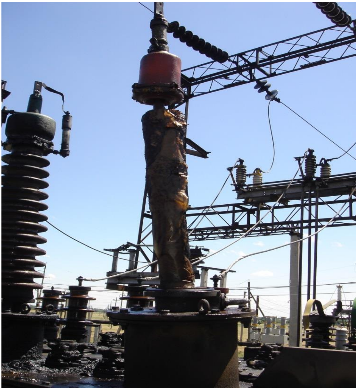
Рисунок 10 – Поврежденный высоковольтный ввод трансформатора
