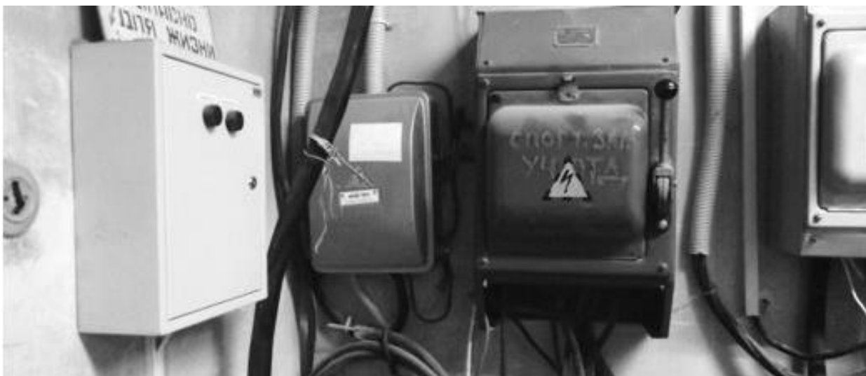
Рисунок 8– Ящики силовые с рубильниками для отдельных помещений
