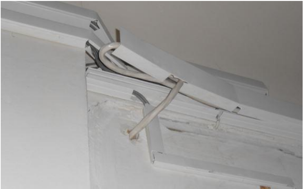
Рисунок 16 – Вышедший из строя кабельный канал
