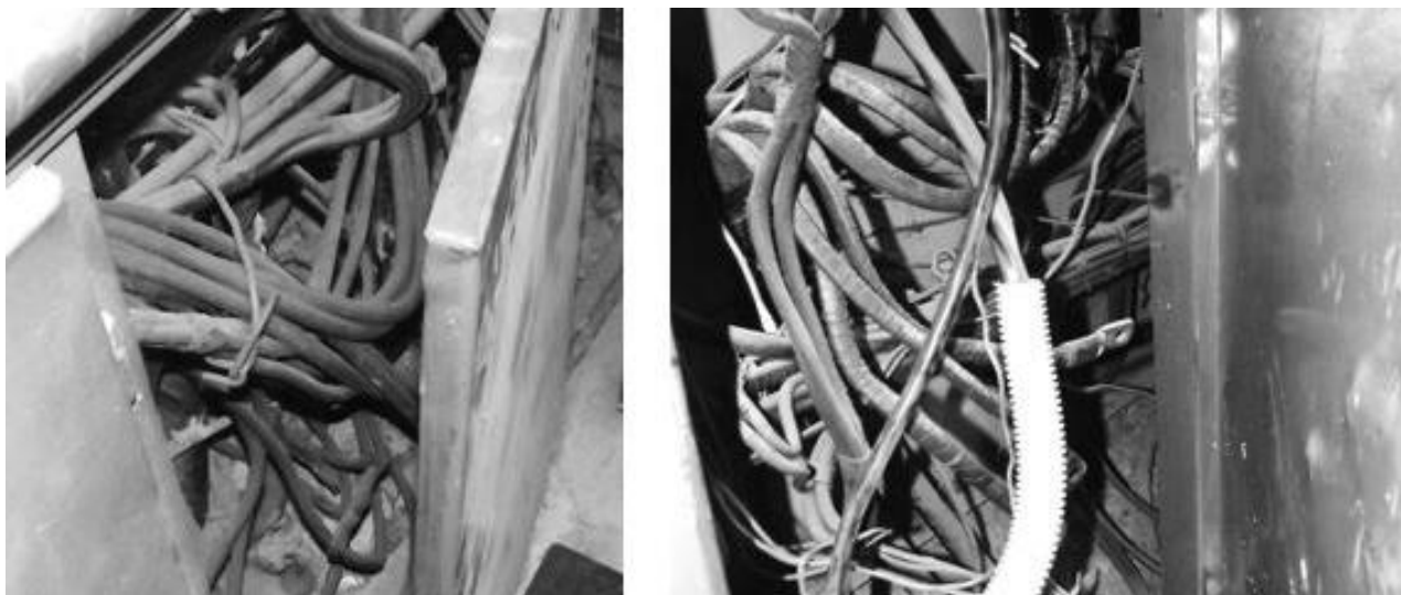
Рисунок 9 – Электрические соединения внутри ВРУ-1
