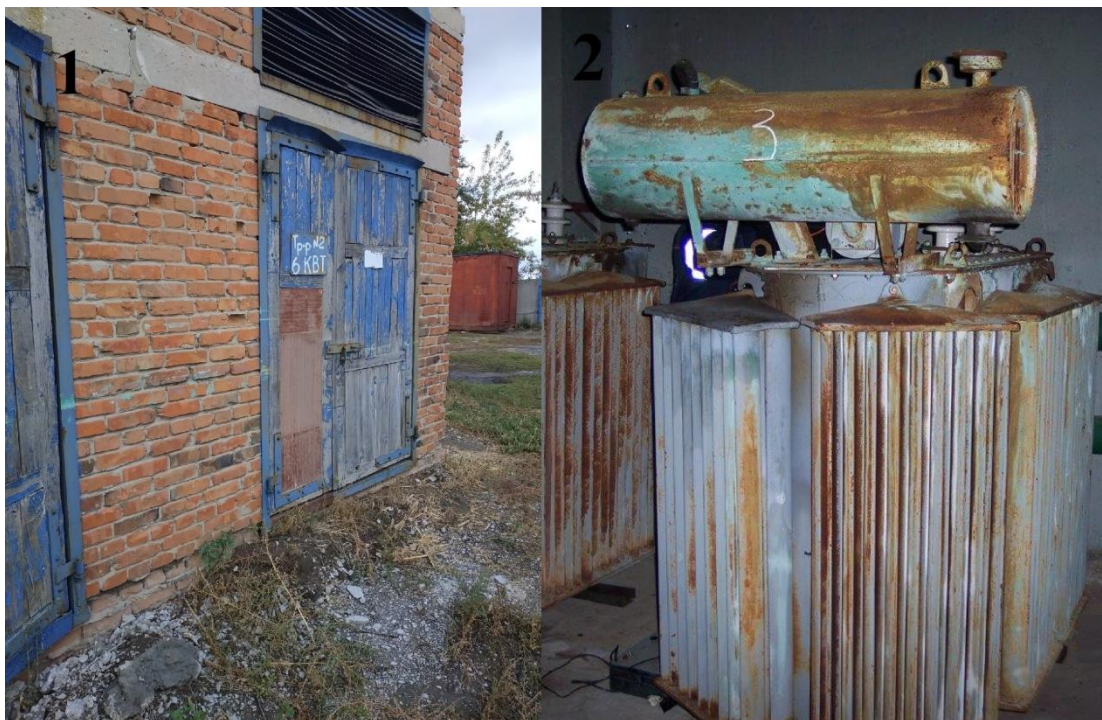
1 – общий вид подстанции с улицы; 2 – резервный трансформатор
