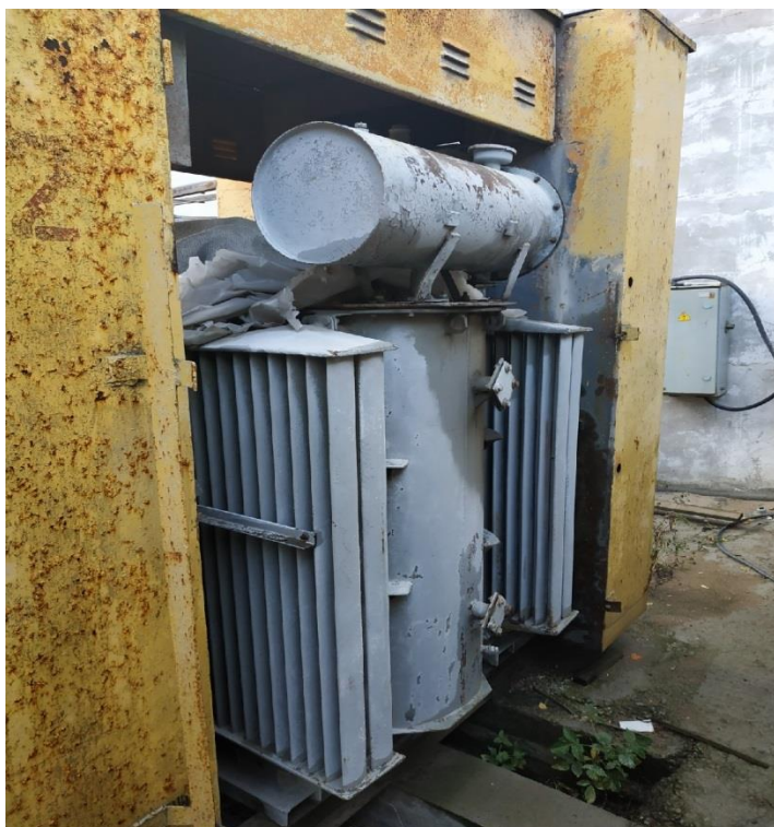
Рисунок 3 – Техническое состояние трансформатора подстанции ТП101
