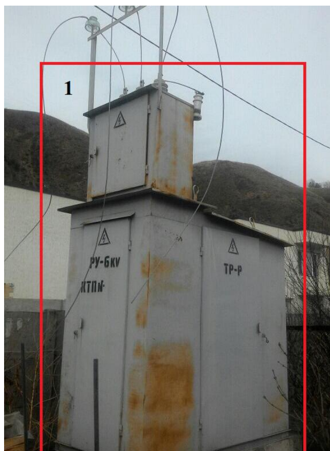
1 - трансформаторная подстанция ТПЗ – 6/0,4 кВ
