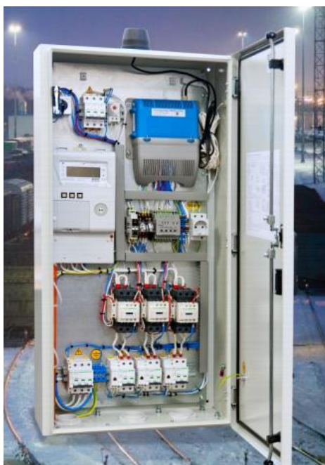
Рисунок 19 – Шкаф управления освещением
