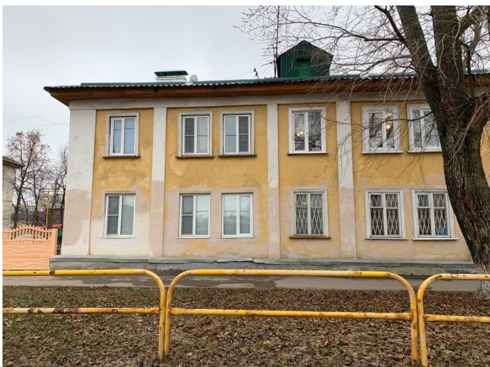
Рисунок 1.4 – Состояние фасадов на улице Мира с пересечением ул. Родины
