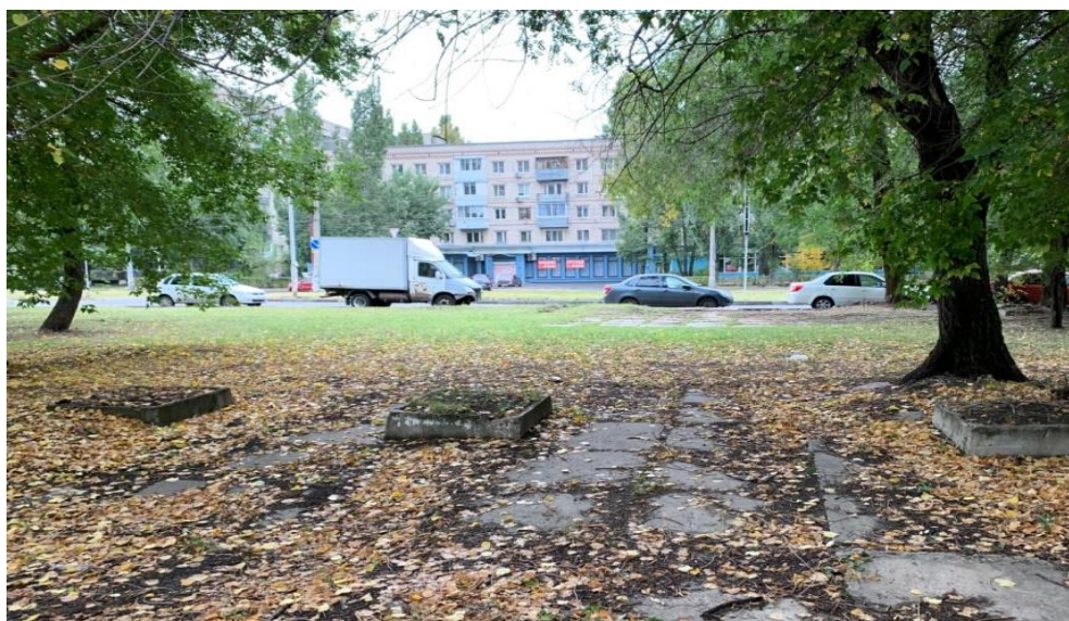
Рисунок 1.5 - Состояние дорожного покрытия территории
