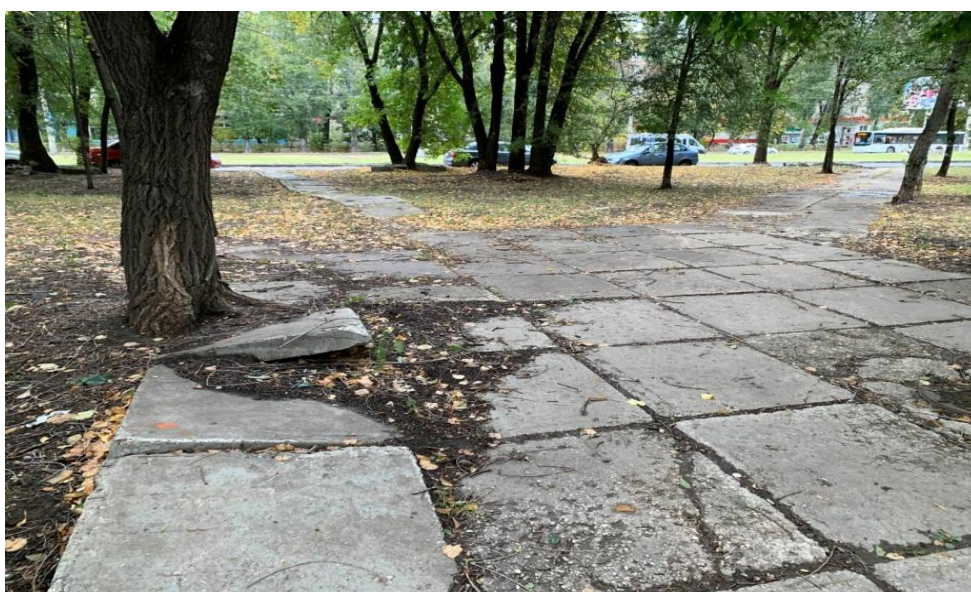
Рисунок 1.6 – Состояние дорожного покрытия территории, прилегающей к улице Мира
