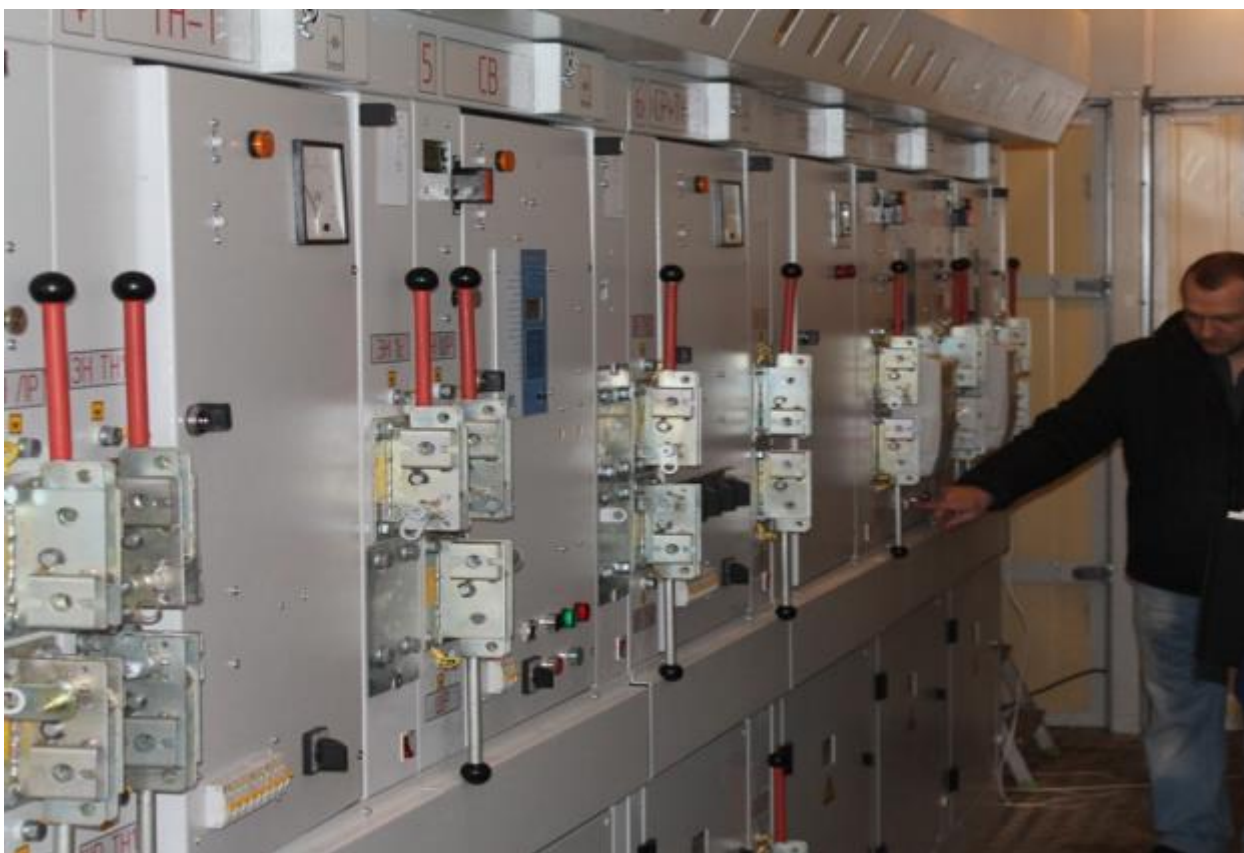
Рисунок 5 - Оборудование секции шин 6 кВ СРП-6 кВ
