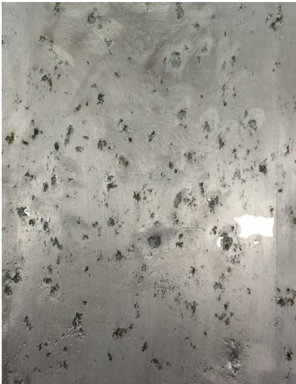
Рисунок 1.2 – Питинговая коррозия корпуса емкости гидратации
