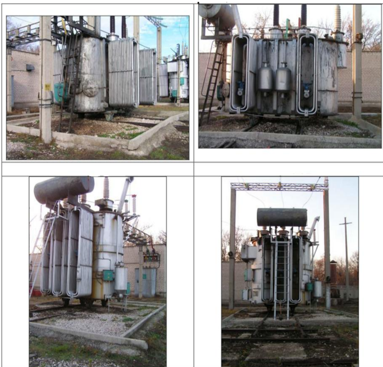
Рисунок 1.2 - Состояние трансформаторов ПС «Восточная»
