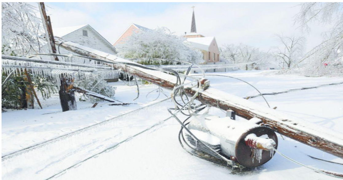
Рисунок 3 – Разрушение опоры ВЛ
