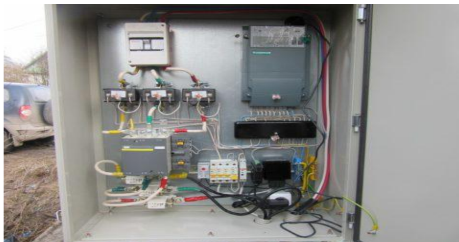
Рисунок 8 – Щит простейшей автоматики уличного освещения
