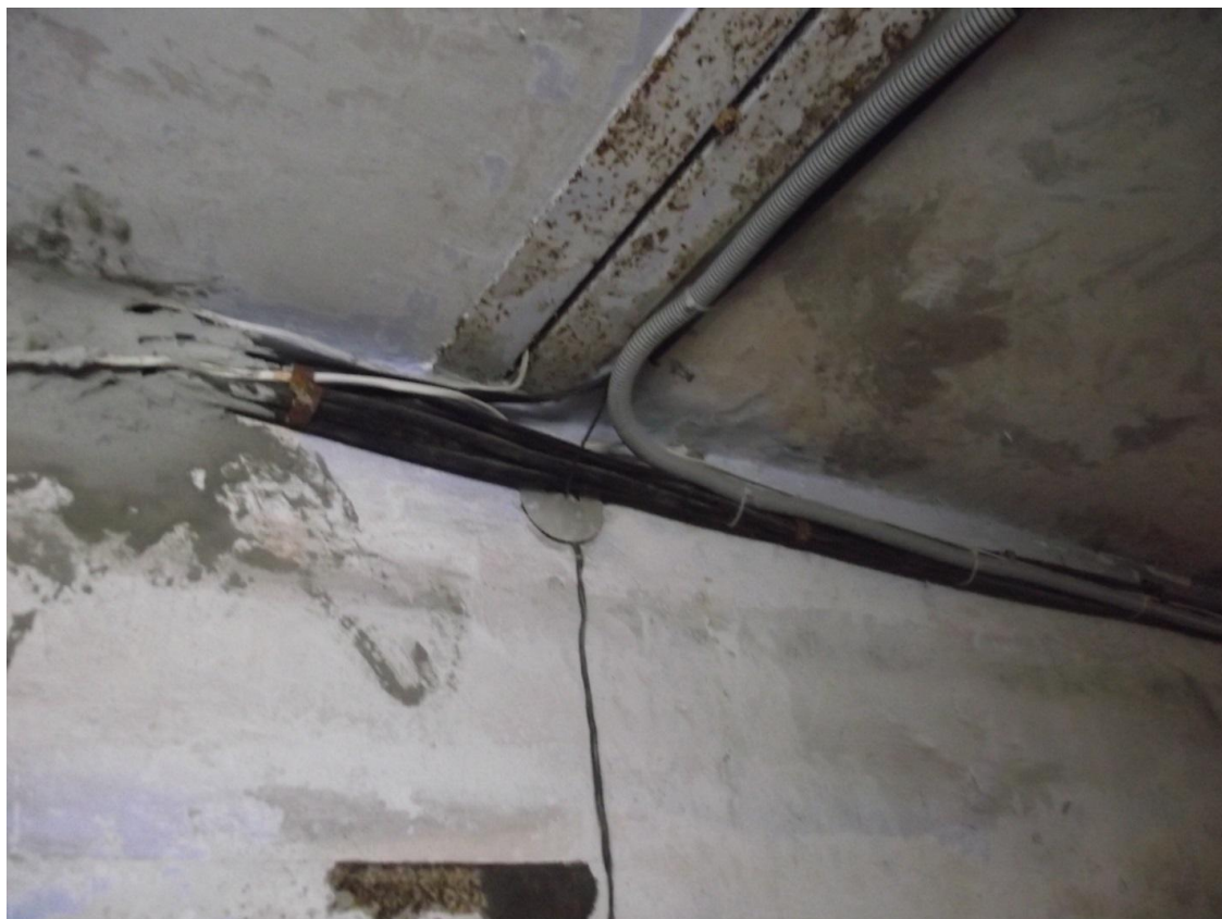
Рисунок 7 - Отсутствие кабельнесущих конструкций
