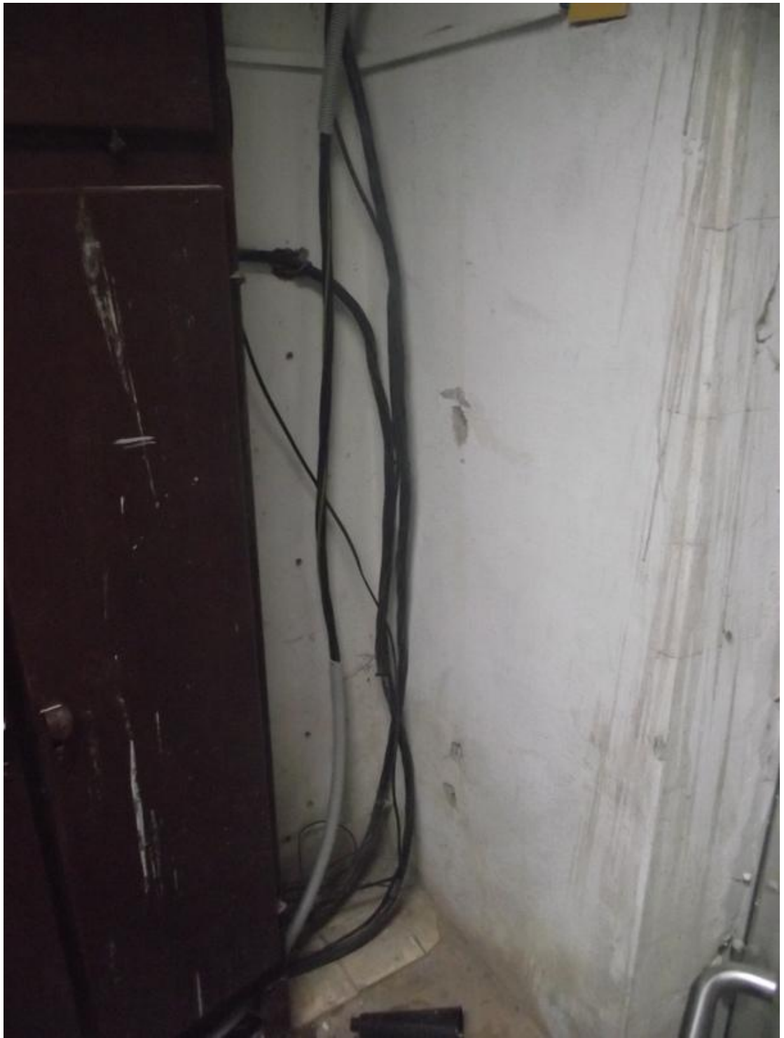
Рисунок 8 - Отсутствие кабельнесущих конструкций
