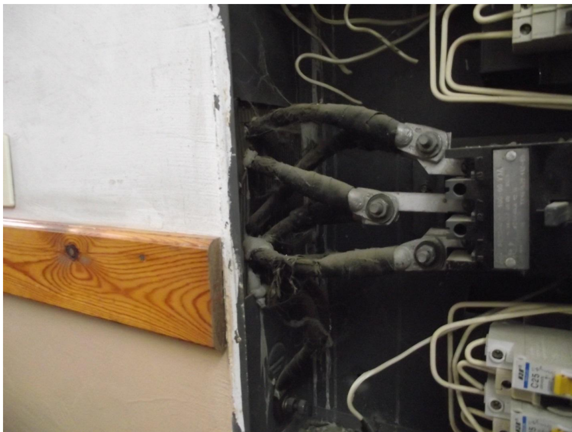
Рисунок 4 - Неудовлетворительное состояние изоляции
