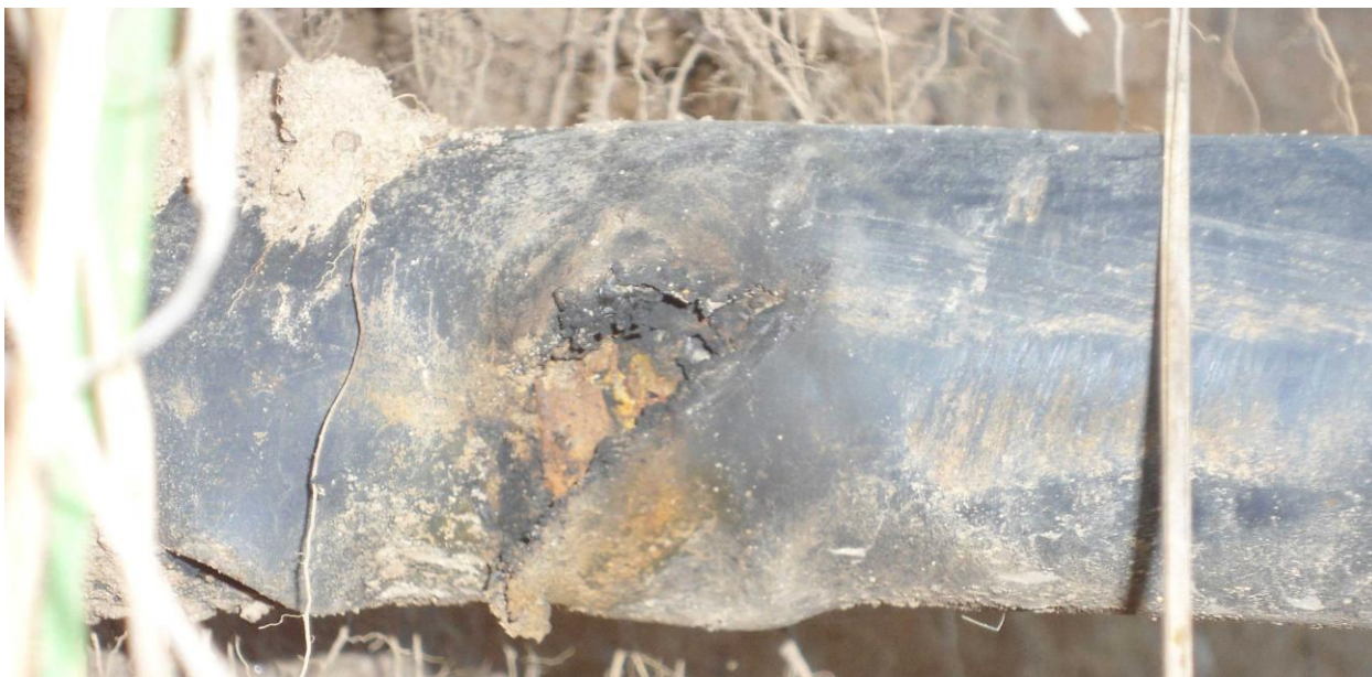
Рисунок 1.3 – Повреждение защитной оболочки силового кабеля
