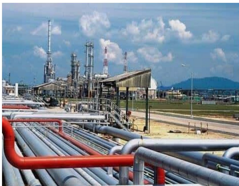
Рисунок 24 – Входная зона в установку УПН
