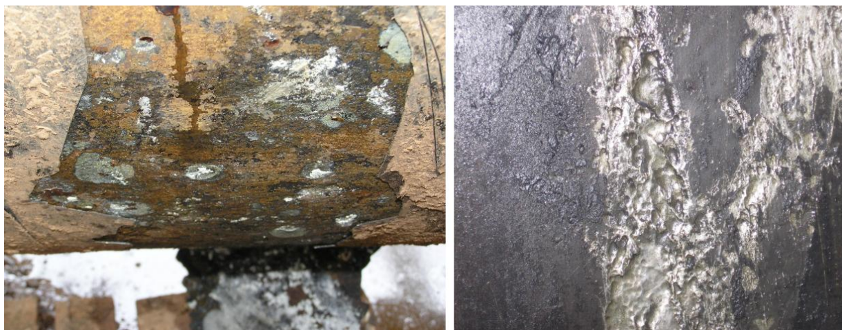
Рисунок 2.4 – Коррозия внешней поверхности трубопровода
