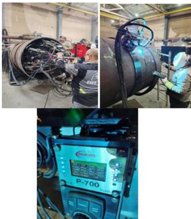
Рисунок 40 – Пример сварки КСС-ААДП-1.1 КСС-ААДП-1.2 КСС-ААДП-1.3 с применением проволоки сварочной GS600, диаметрами 0,9 мм (корневой слой) и 1,0 мм (последующие слои)
