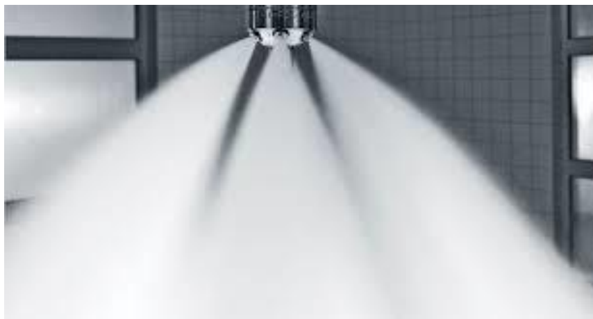
Рисунок 8 – Срабатывание аэрозольной противопожарной системы
