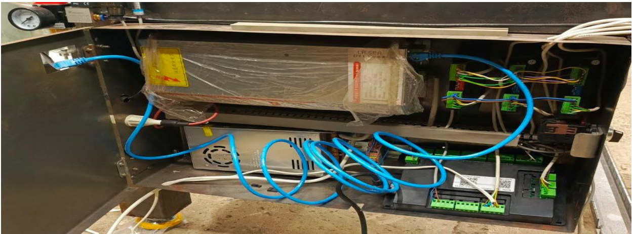
Рисунок 17 – Общий вид электрошкафа
