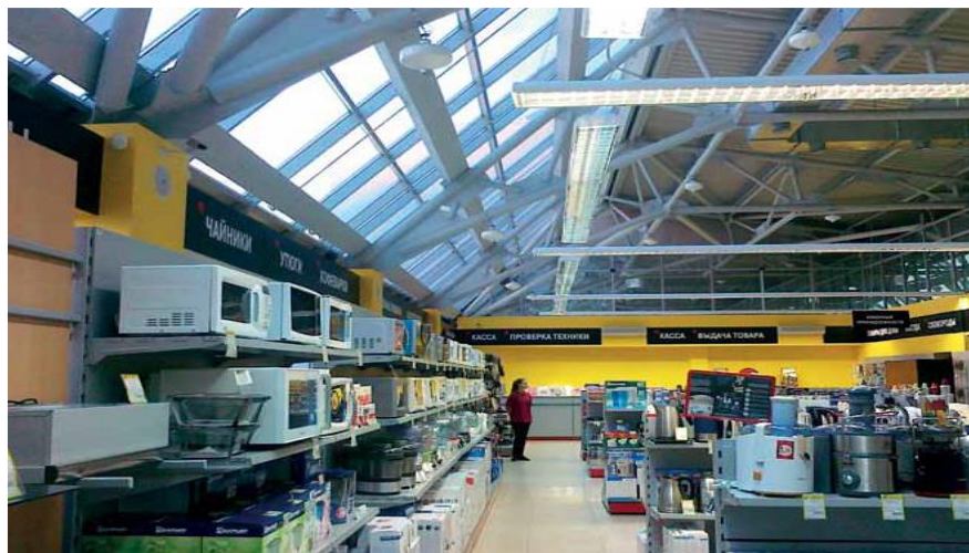
Рисунок 4 – Установка МПП «Ураган-5М», высотного исполнения в крупных торговых залах
