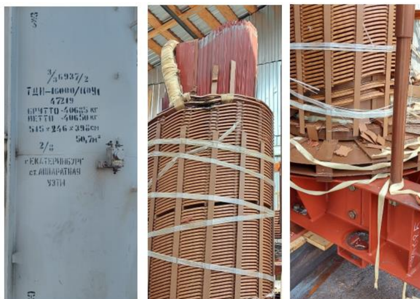
Рисунок 15 – Силовой трансформатор ТДН-16000/100У1
