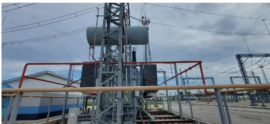
Рисунок 45 – Силовой трансформатор на территории подстанции
