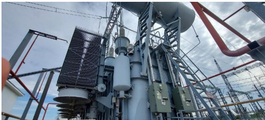
Рисунок 44 – Силовой трансформатор, находящийся на территории подстанции
