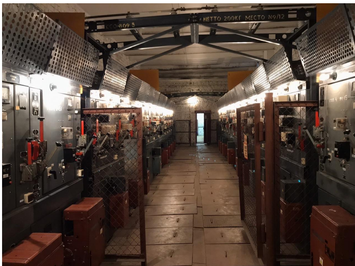
Рисунок 1 – Помещение ЗРУ-10/6кВ повысительной насосной станции.
