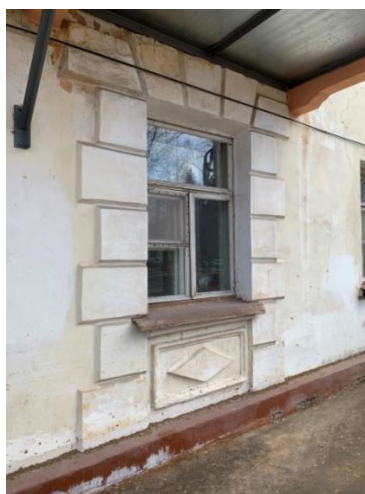
Рисунок В.9 – Руст на оконном проеме
