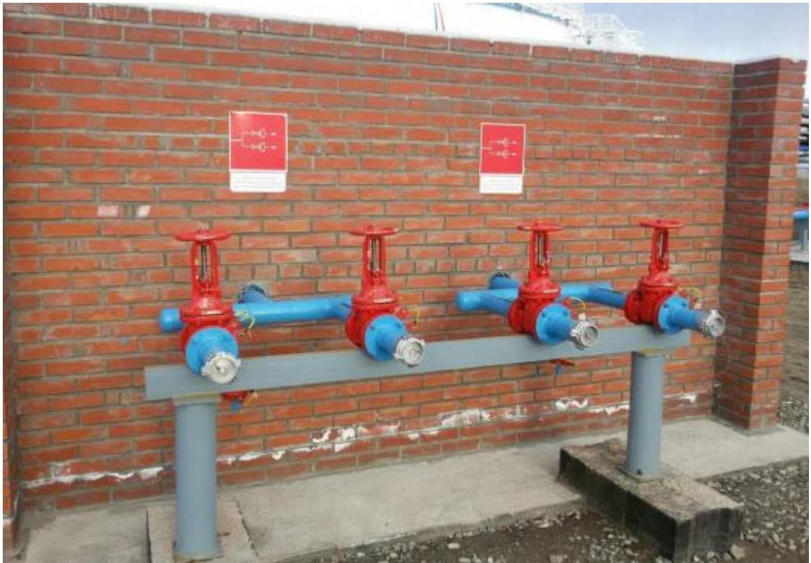
Рисунок 1.12 – Узел подключения водяного охлаждения
