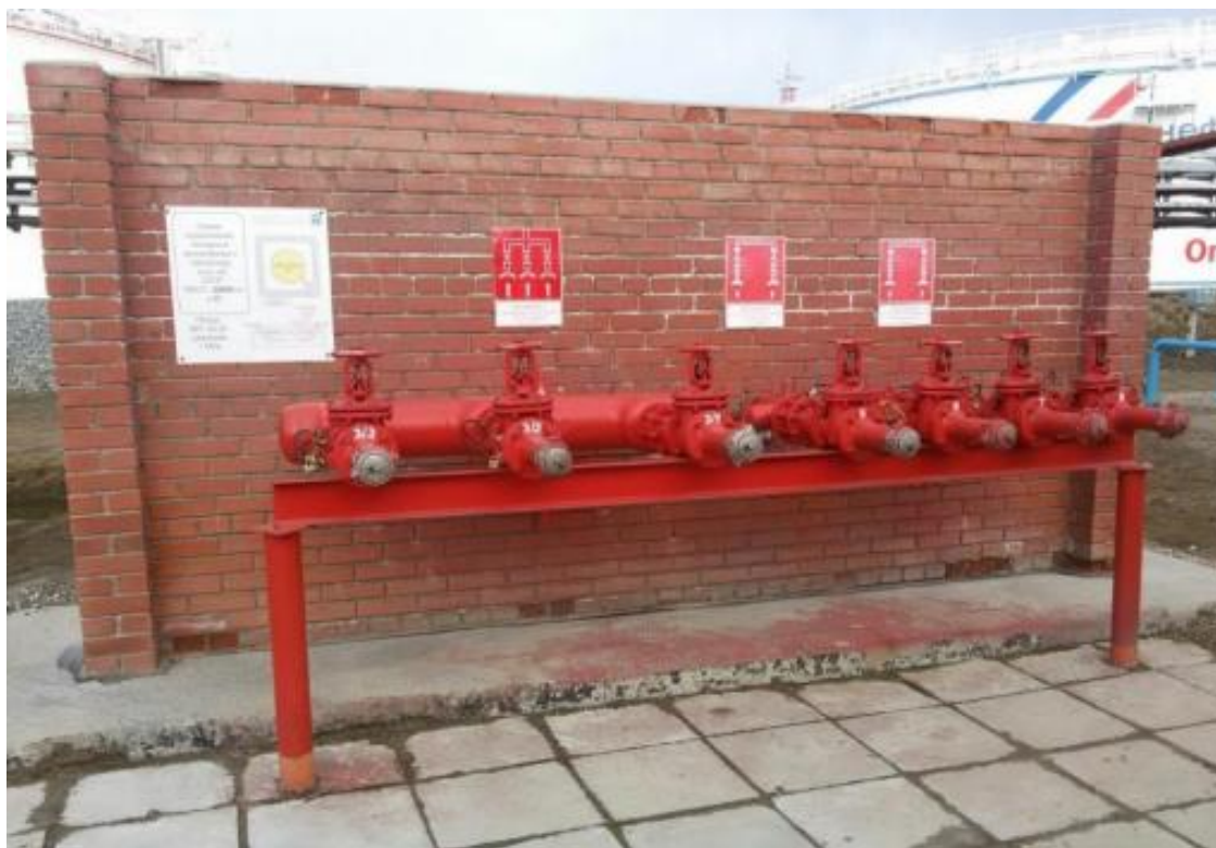
Рисунок 1.11 – Напорный узел СППТ ЛПДС «Клин» ПРУ АО «Транснефть-Дружба»
