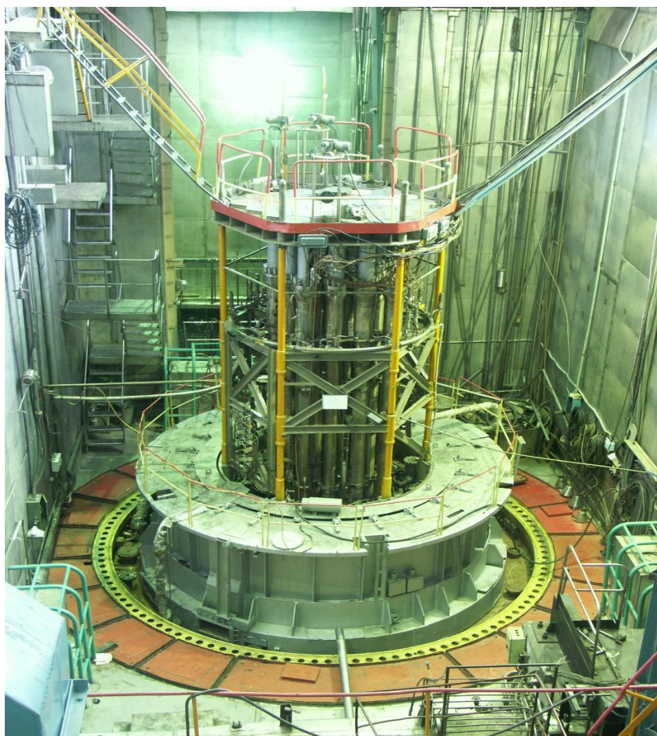
Рисунок 3 - Верхняя часть реактора ВК 50 со снятым защитным колпаком
