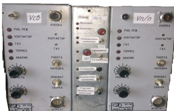
Рис 4.15 Блок управления лабораторной установкой
