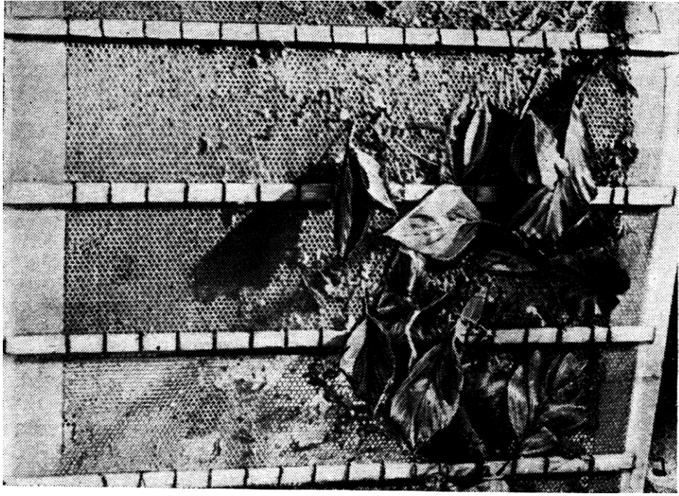
Рисунок 1.28 – Загрязнения на секциях вращающейся сетки
