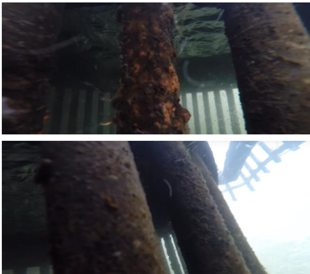
Рисунок 2.7 – Кадры водолазного видеообследования защитных решеток на всасывающих трубопроводах при обследовании плавучего водозабора ТЭЦ-2 в г. Уфа
