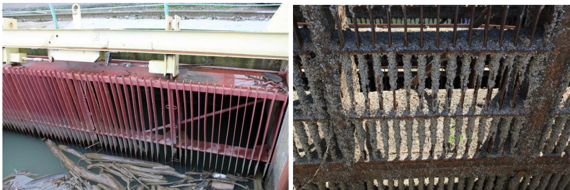
Рисунок 2.5 – Топляк возле решетки и решетка подверженная биообрастанию и коррозии
