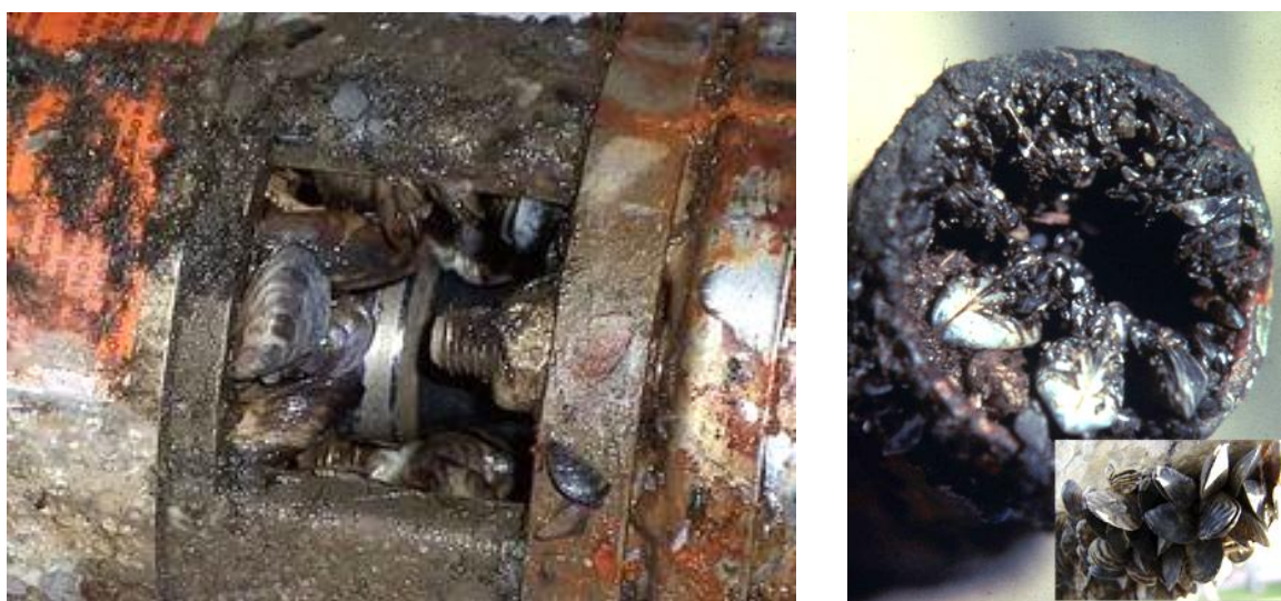
Рисунок 2.4 – Дрейссена заблокировавшая насос и трубопровод
