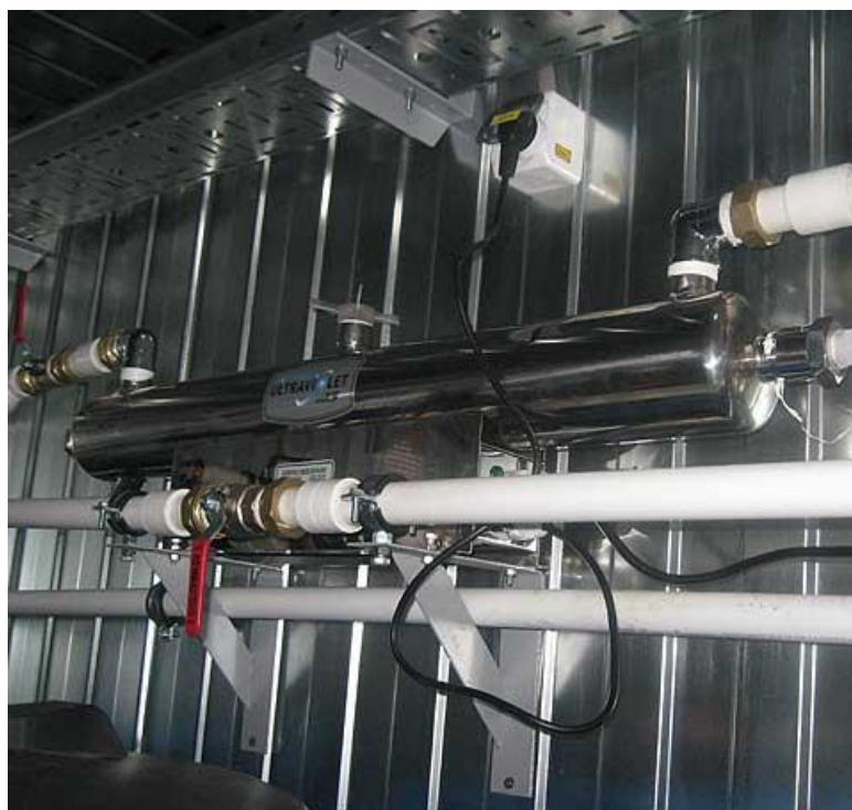
Рисунок 2.14 – Фото установки для УФ - обеззараживания воды
