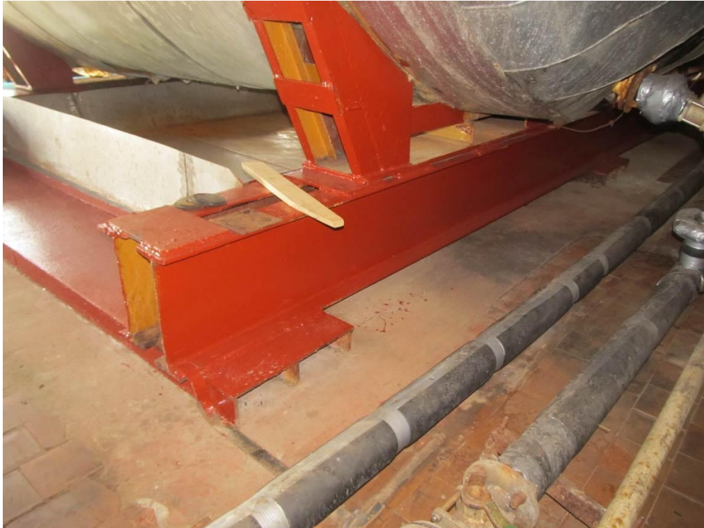
Рисунок А.3 – Узел передачи нагрузки со стальной рамы на плиты перекрытия в осях «25-26»
