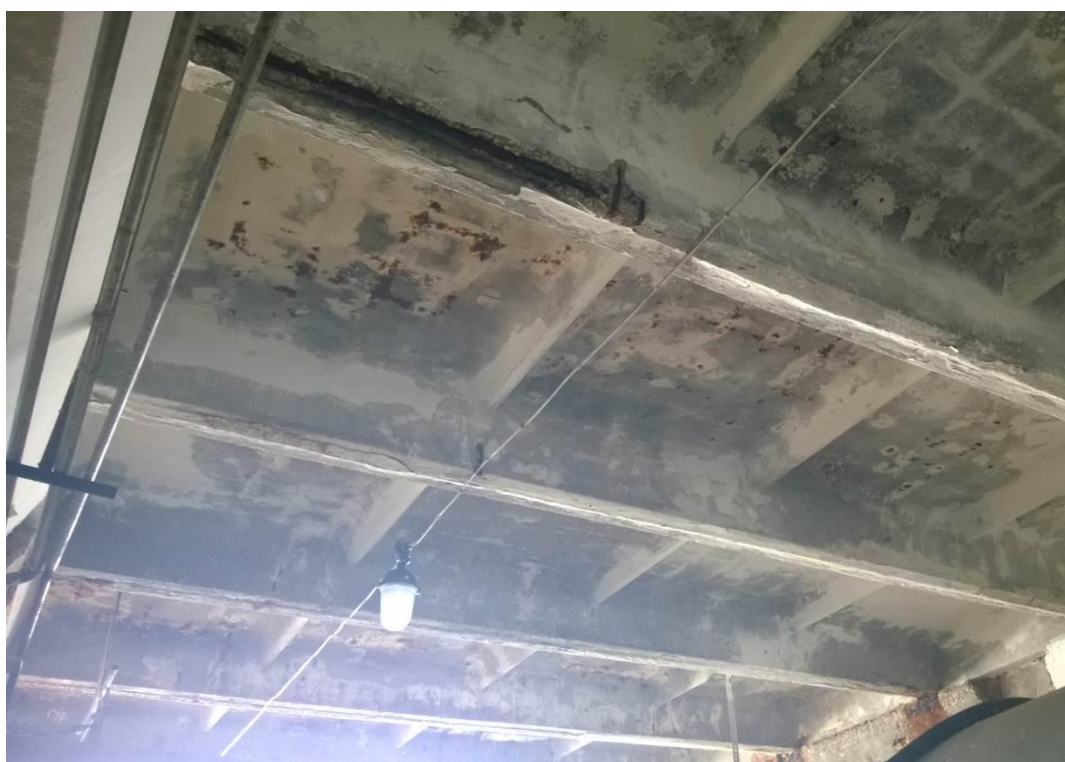
Рисунок А.8 – Разрушение защитного слоя бетона плиты перекрытия в опорной зоне
