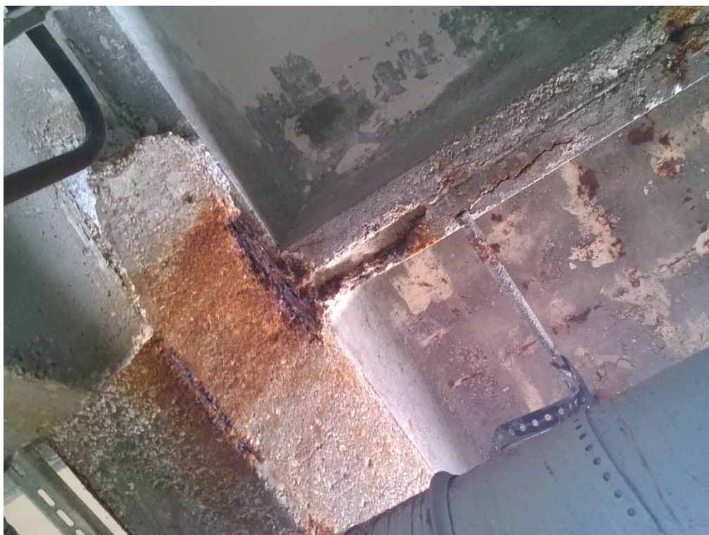
Рисунок А.7 – Разрушение защитного слоя бетона плиты перекрытия в опорной зоне
