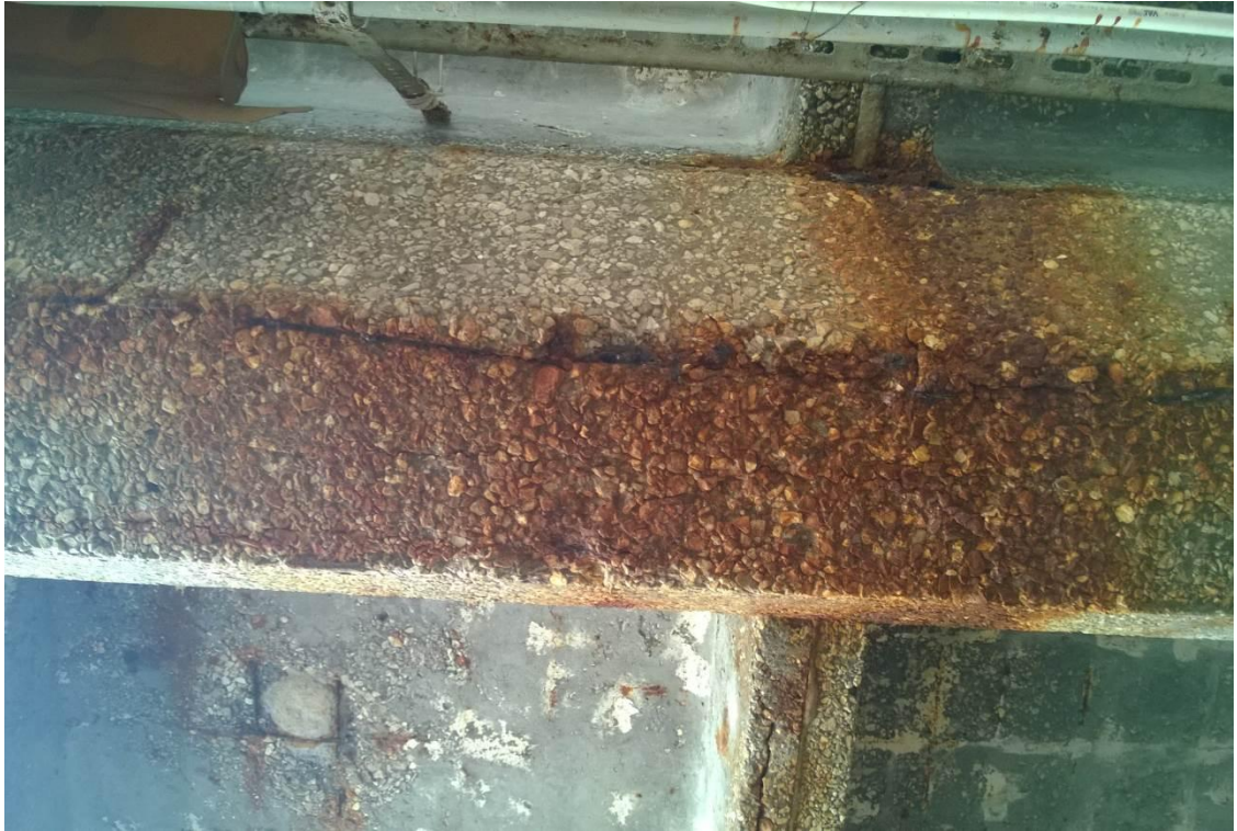
Рисунок А.9 – Коррозия ригеля в осях «У-Ф/26». Деструкция цементного камня. Обнажение крупного заполнителя
