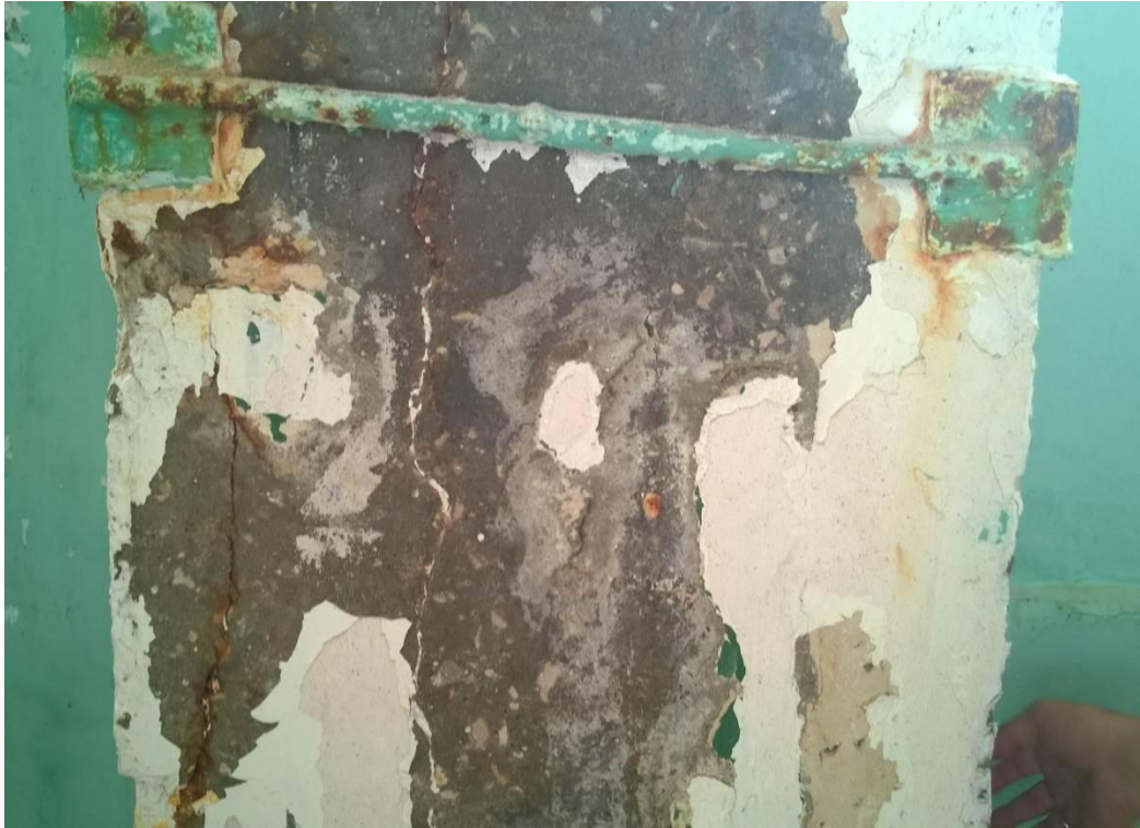
Рисунок А.11 – Коррозия колонны в осях «Ф/26». Разрушение защитного слоя бетона
