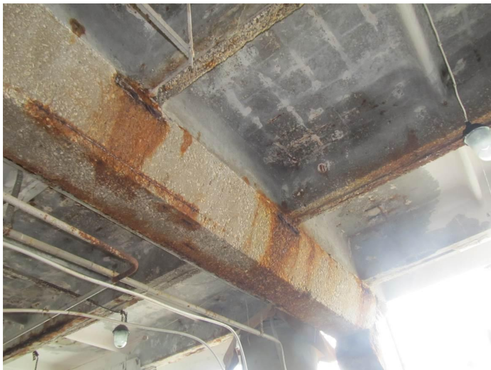
Рисунок А.10 – Коррозия ригеля и закладных деталей
