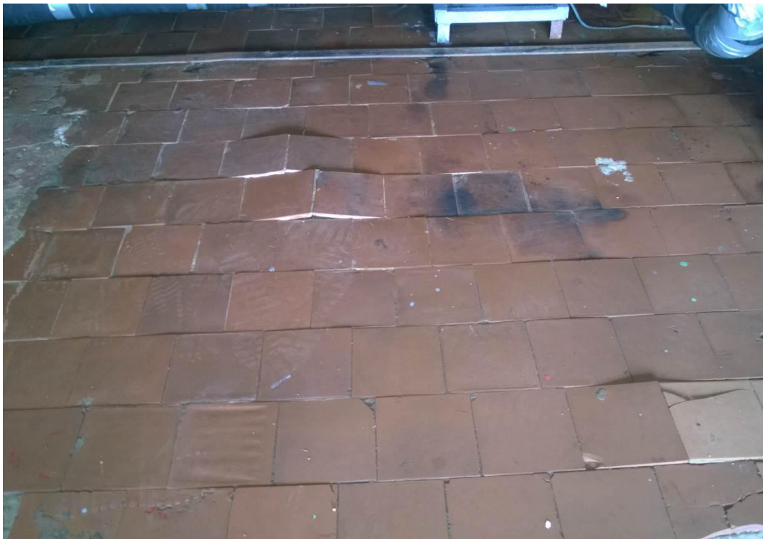
Рисунок А.2 – Выпирание плитки пола на отм. +4.200
