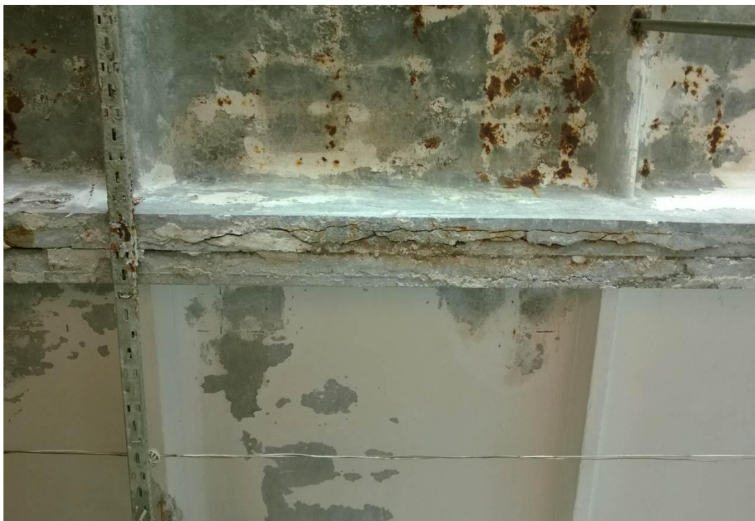
Рисунок А.6 – Разрушение защитного слоя ребер плит перекрытия на отм. +3.300. Коррозия арматуры плитной части
