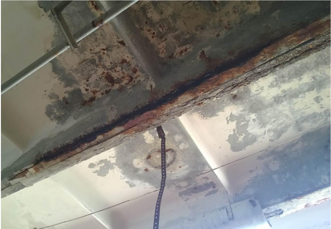
Рисунок А.5 – Коррозия арматуры. Разрушение защитного слоя бетона плит перекрытия на отм. +3.300
