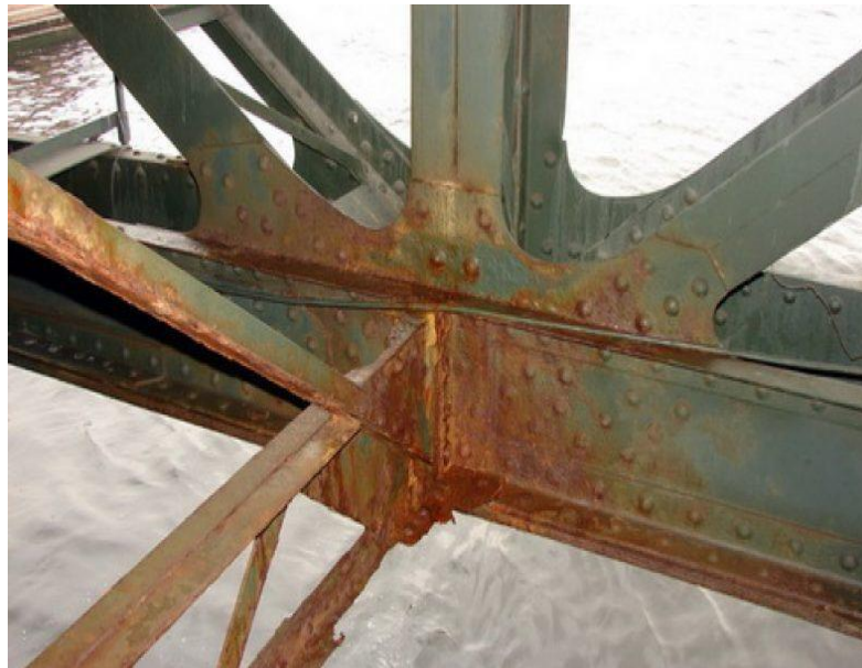
Рисунок 5 – Сплошная коррозия узла фермы
