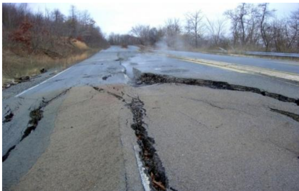
Рисунок 4 – Разрывы на дорожном покрытии
