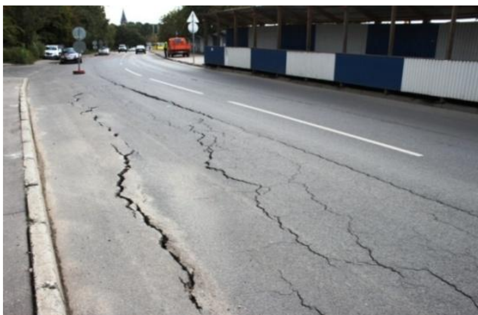
Рисунок 9 – Продольные трещины на поверхности
