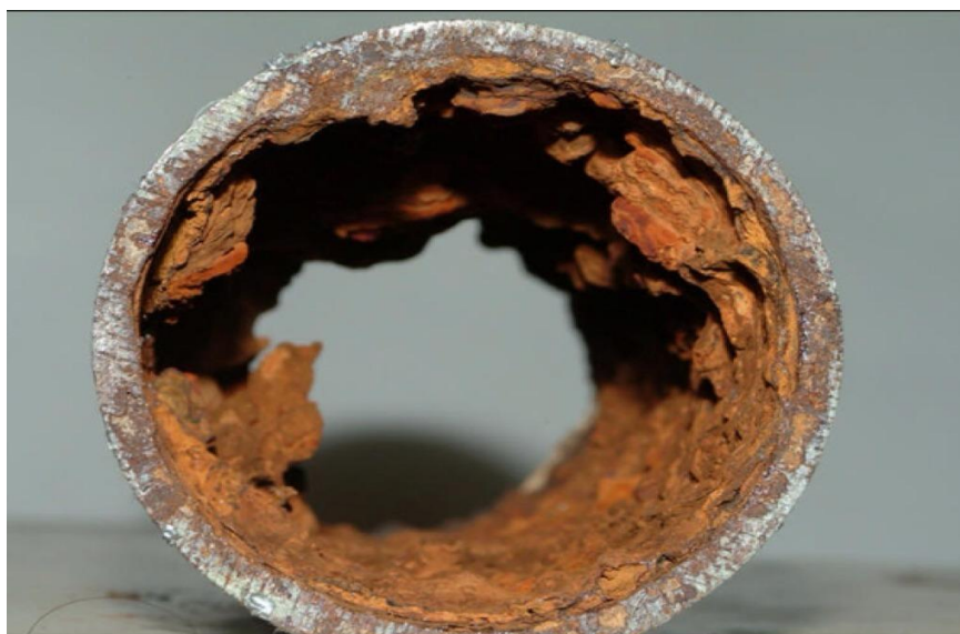
Рисунок 1 – Коррозионный процесс разрушения трубопровода
