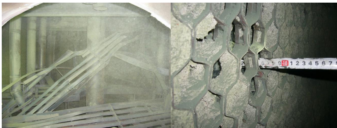
Рис. 4.1 Поломки внутренних конструкции реактора: решетки (слева) и футеровки (справа)
