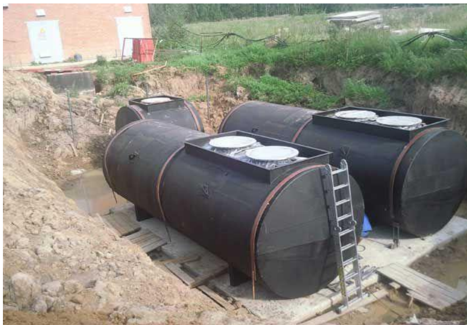
Рисунок 7 – Подземные пожарные резервуары
