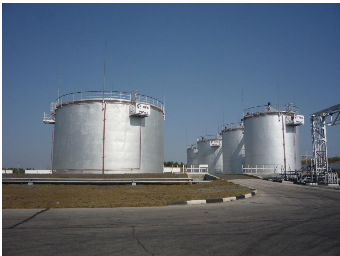
Рисунок 10 – Резервуарный парк ЛВЖ, ГЖ
