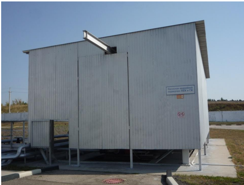
Рисунок 13 – Насосная станция аварийной перекачки
