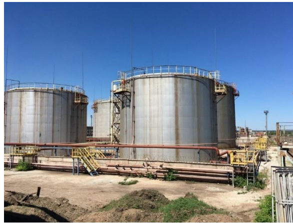
Рисунок 1.2– Вид на резервуарный парк с восточной стороны
