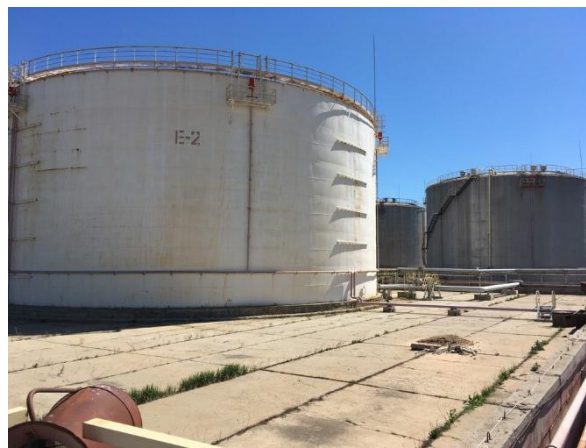
Рисунок 1.4 – Вид на резервуарный парк с западной стороны
