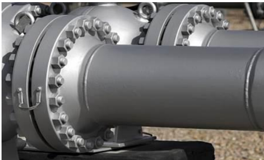
Рисунок 1.10 – Общий вид фланцевого соединения технологического трубопровода
