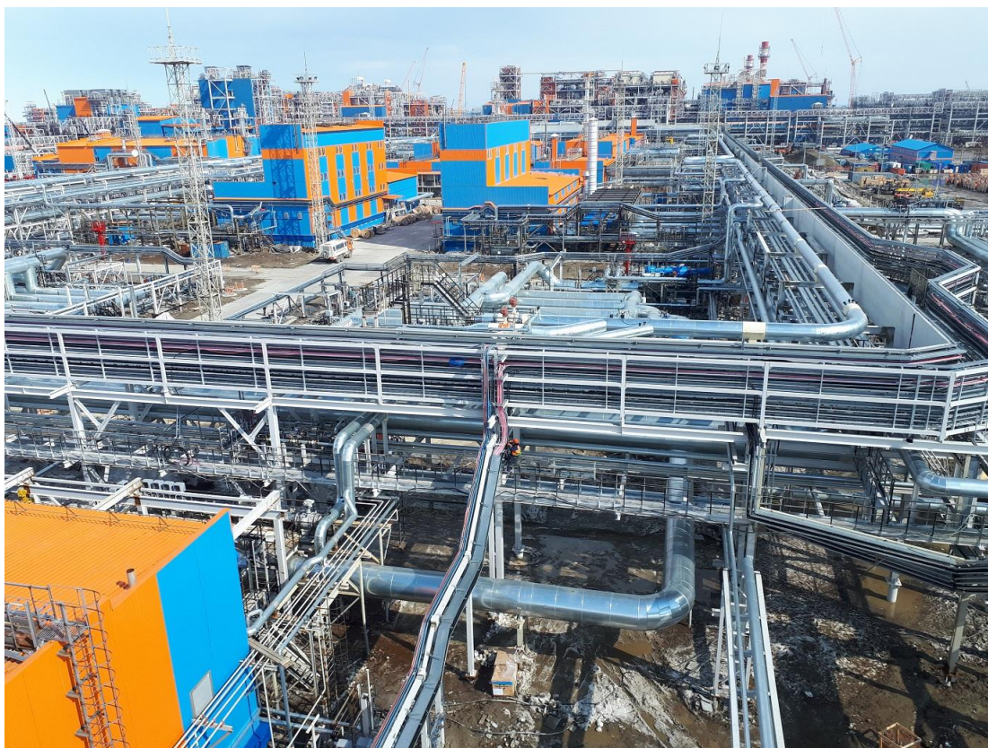
Рисунок 1.7 – Общий вид межцеховых технологических трубопроводов
