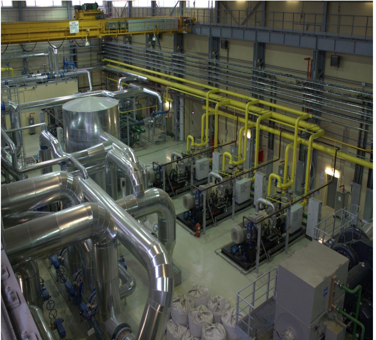
Рисунок 1.6 – Общий вид внутрицеховых технологических трубопроводов
