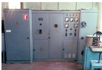
Рис. 17 Установка высокочастотная тип ЛПЗ-67
