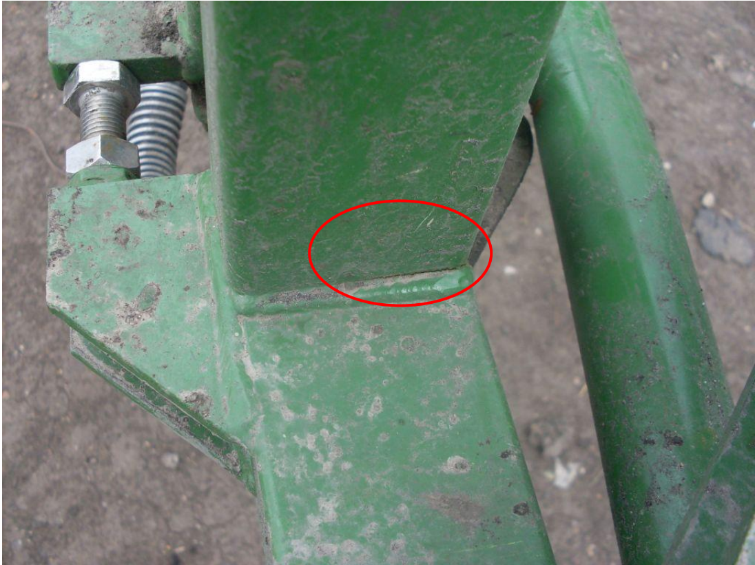
Рисунок 1.1 – Трещина в сварном соединении на средней секции крыла UR 3000, образовавшаяся в результате удара
