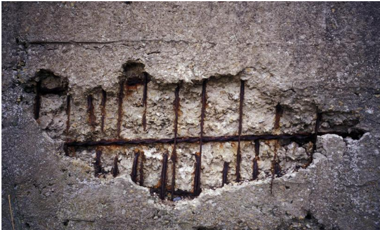
Рисунок 1.3 – Коррозия стальной арматуры в железобетоне
